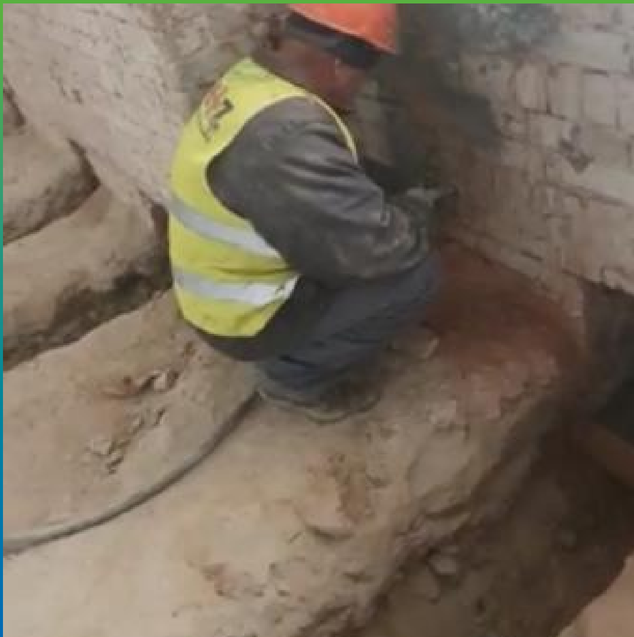
Дефекты пола до начала ремонтных работ
