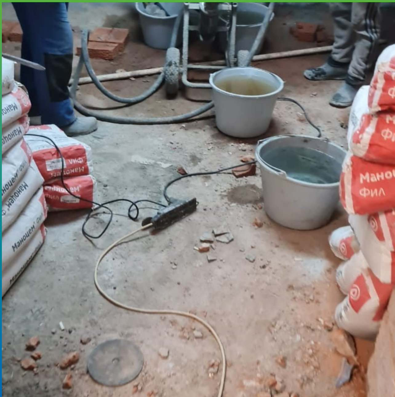
Насос БМП 6 подготовленный к работе
