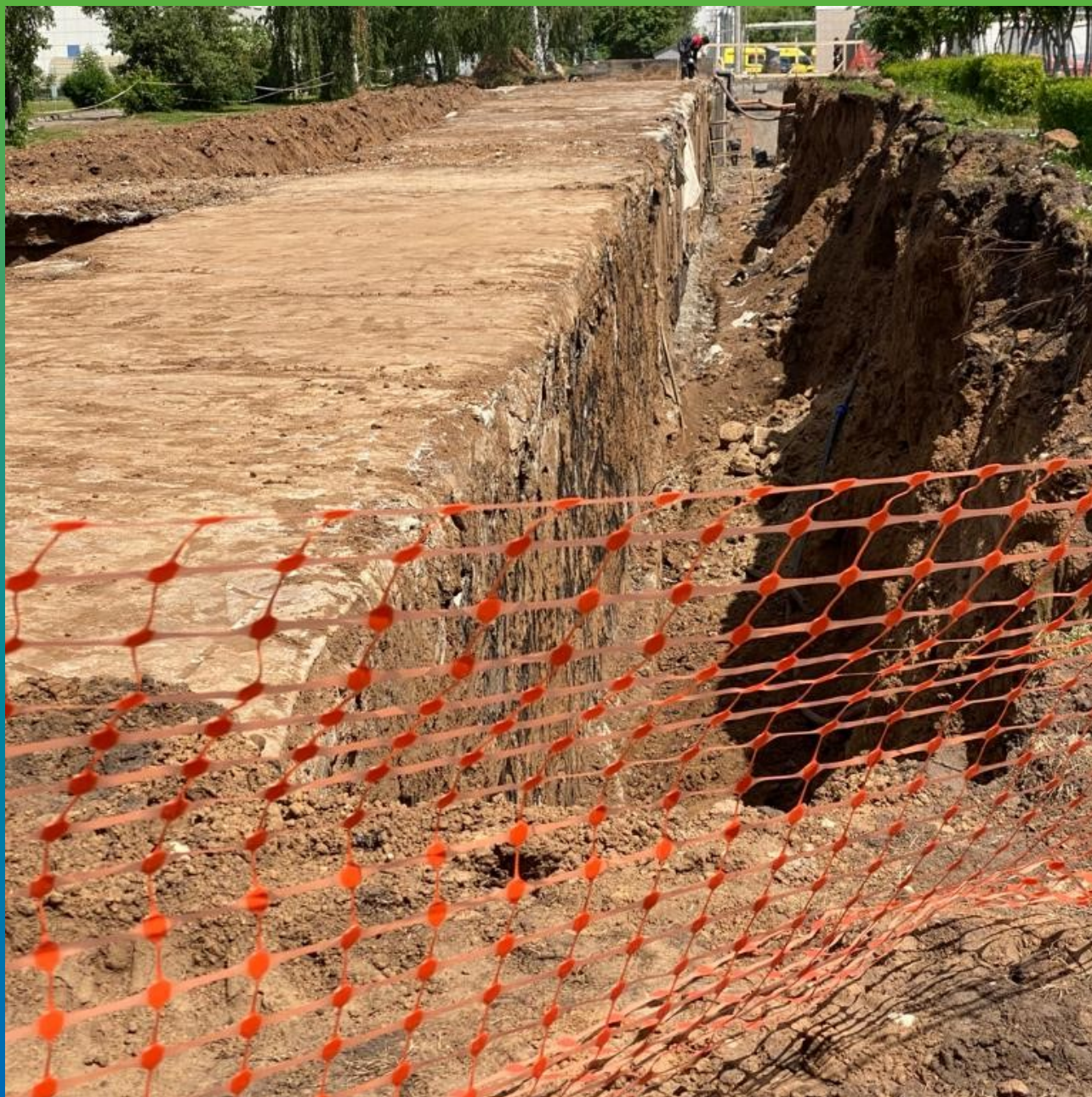
Подземный переход ДРКБ, требующий гидроизоляции, вид до начала работ
