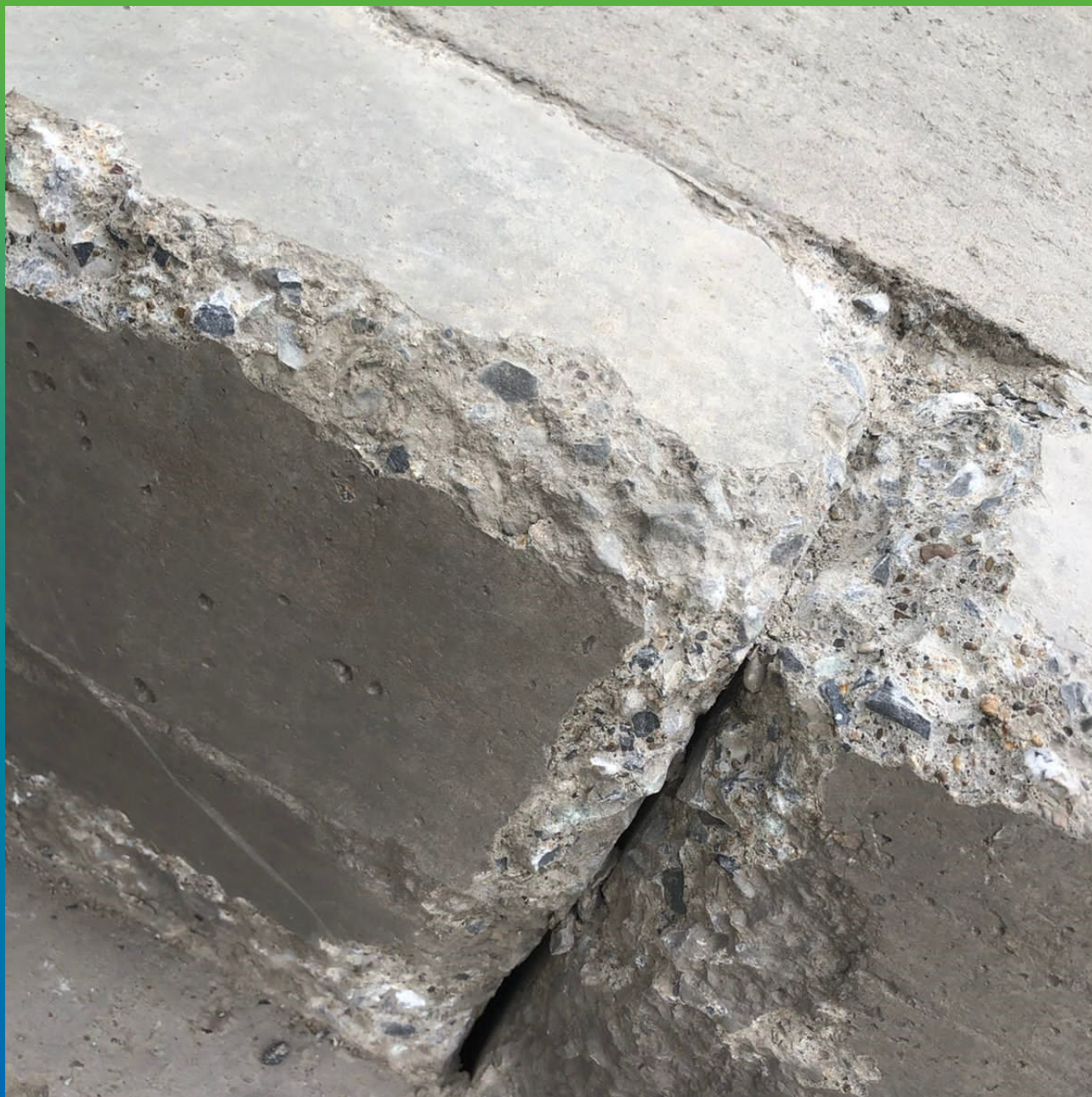
Разрушенные бордюрные камни по ул. Правобулачная
