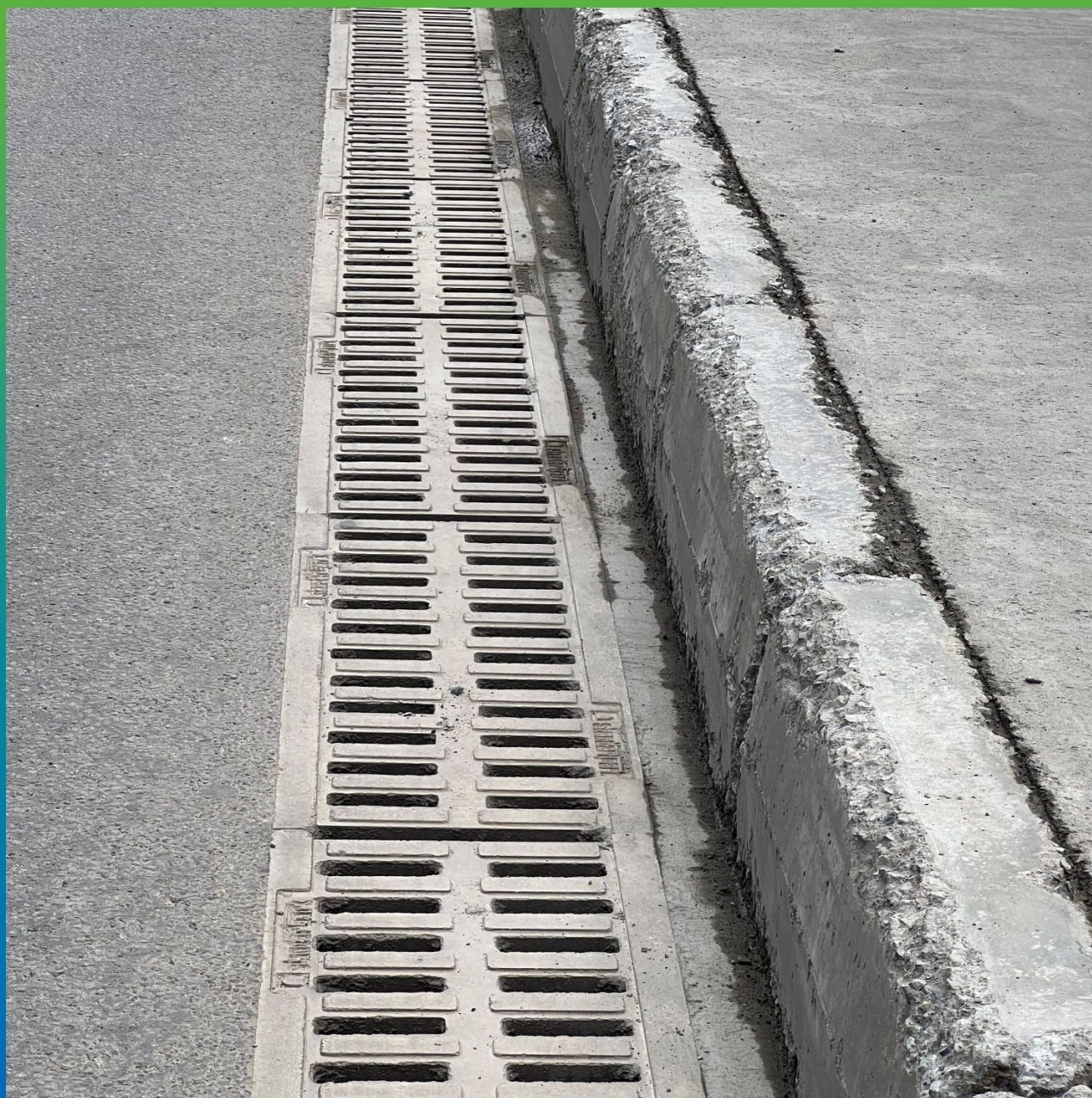
Разрушенные бордюрные камни по ул. Правобулачная
