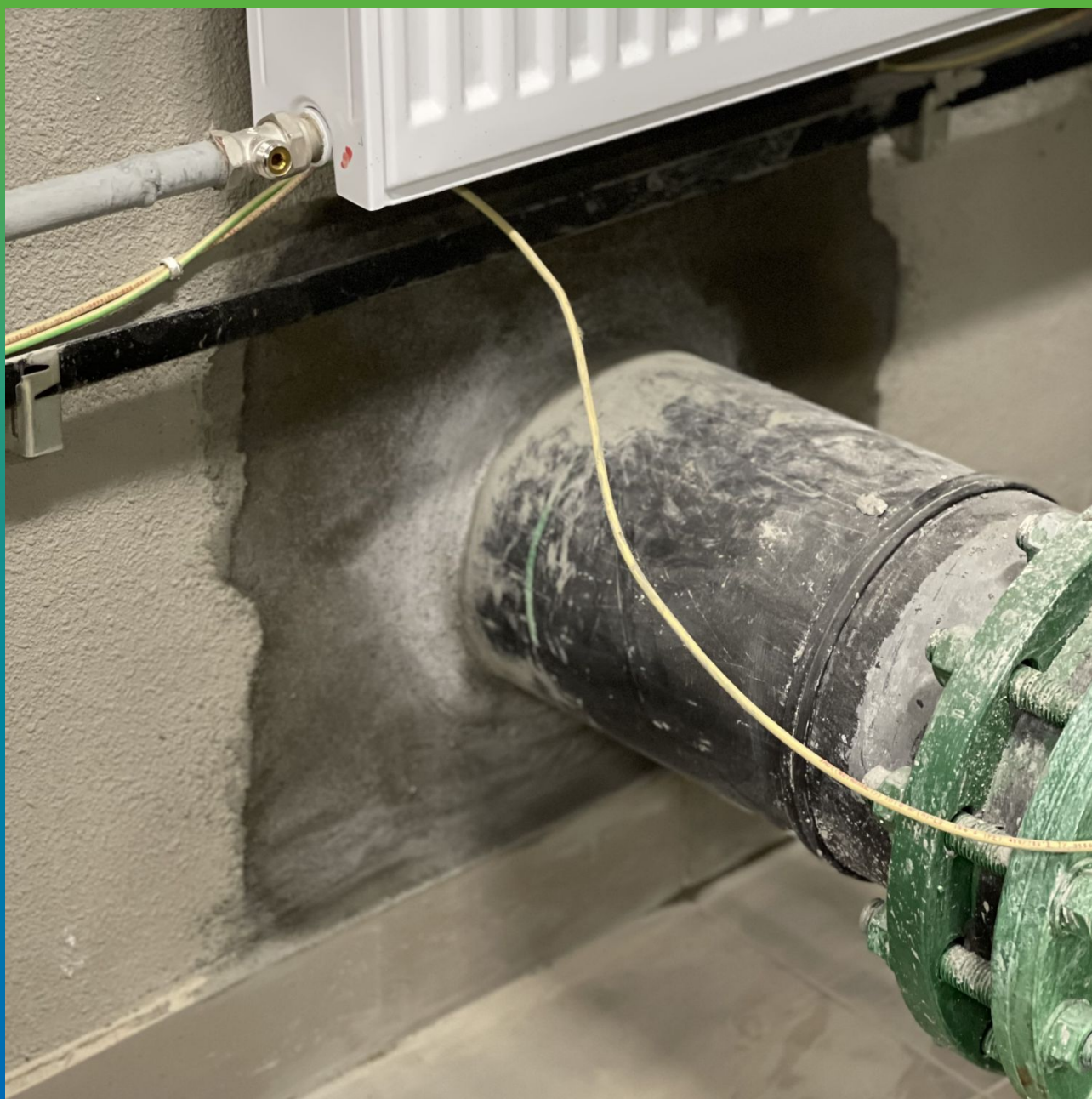
Зачеканенный ввод коммуникаций
