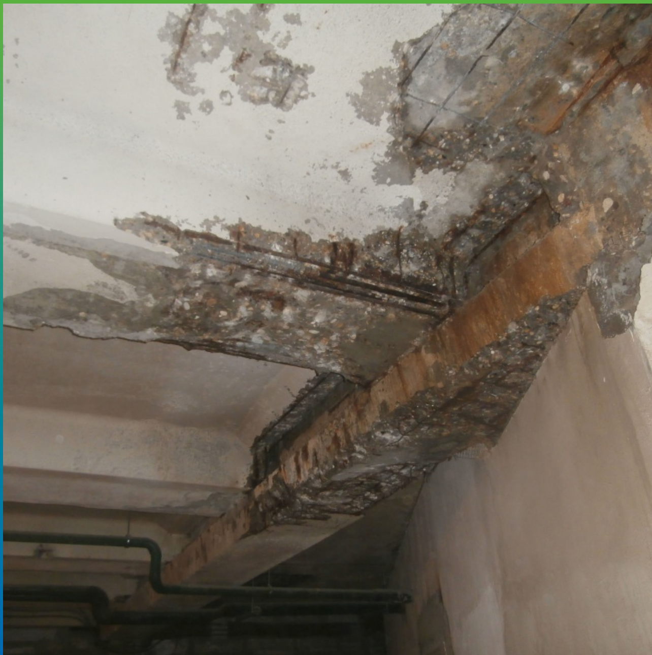
Разрушение бетона и коррозия арматуры
