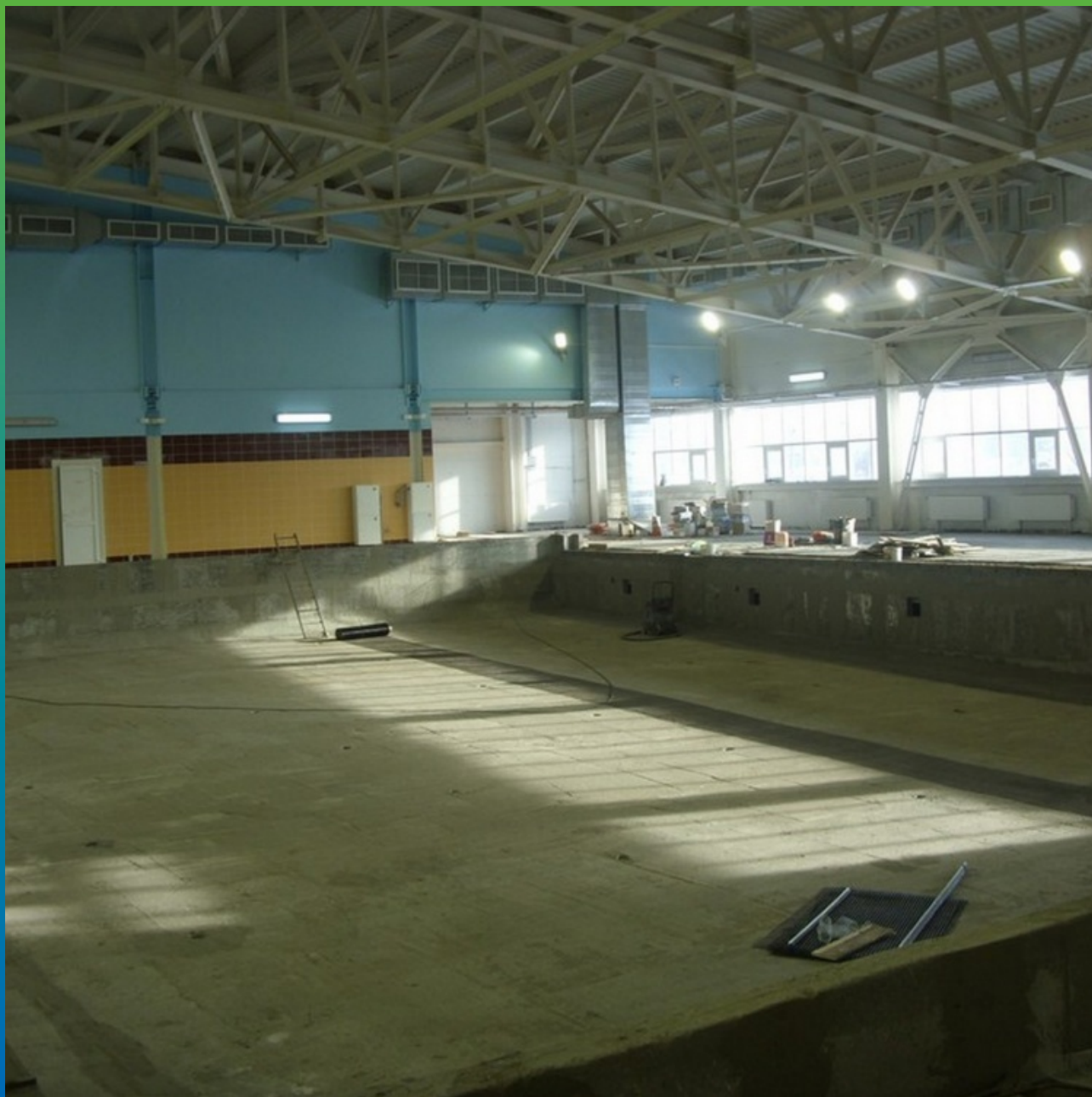
Чаша бассейна до производства работ по ремонту и гидроизоляции
