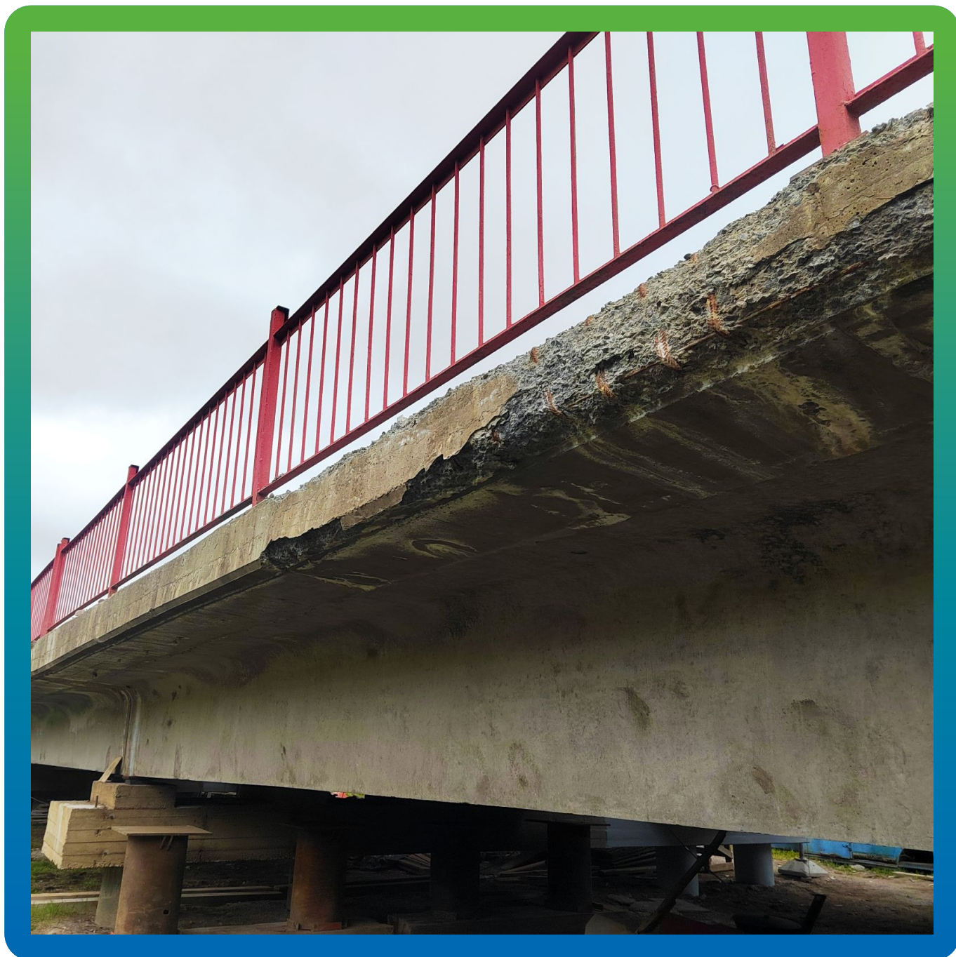
Вид дефектов пролетов моста до ремонта.
