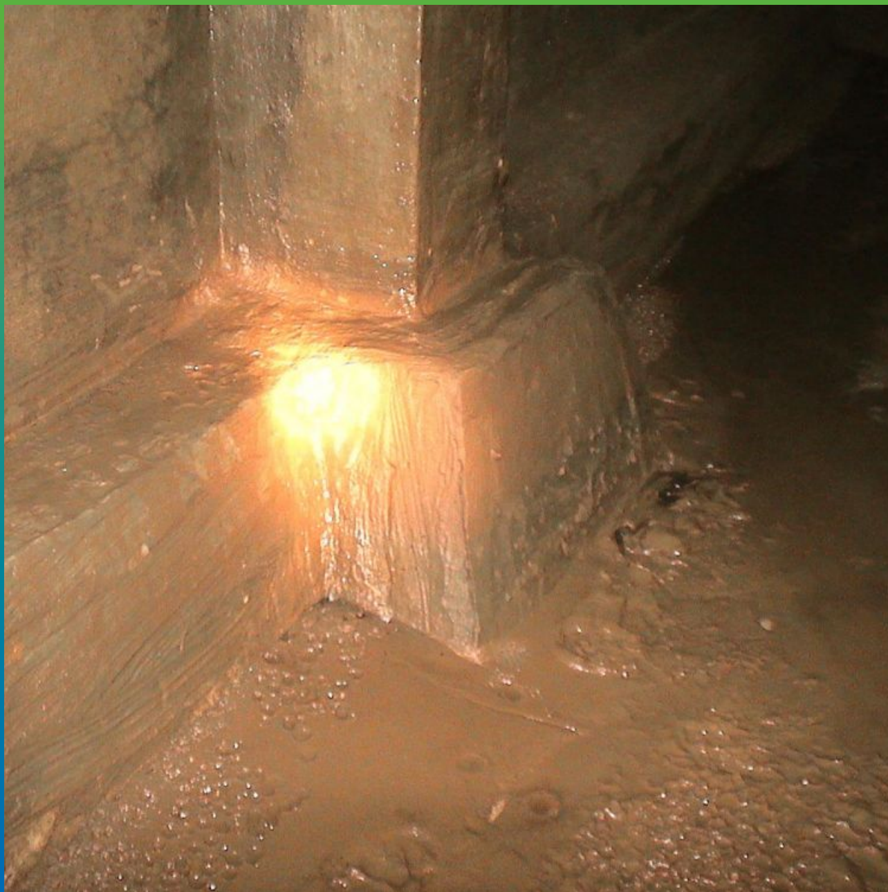
Дефекты конструкции до начала проведения работ
