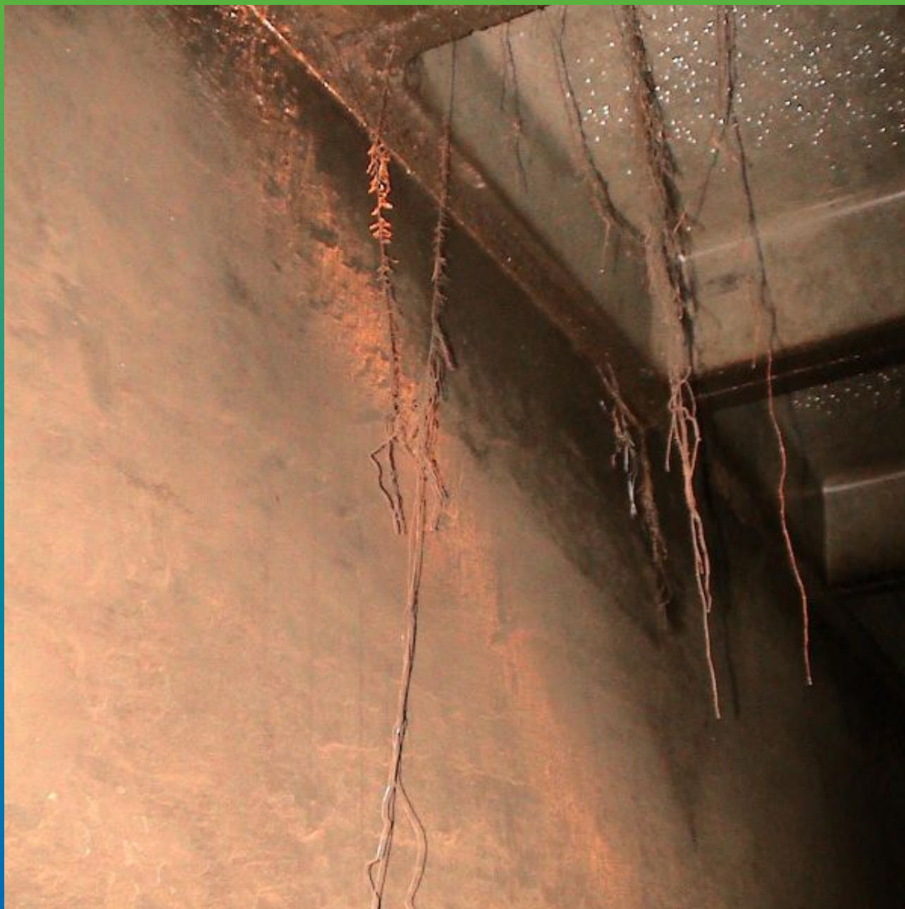
Дефекты конструкции до начала проведения работ
