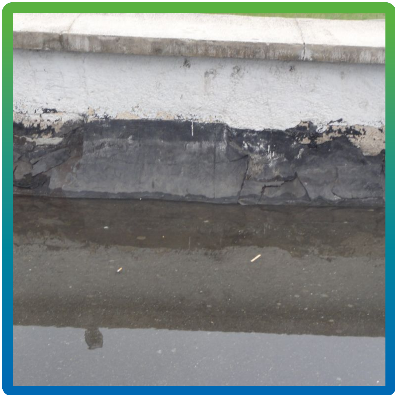
Дефекты существовавшего слоя гидроизоляции
