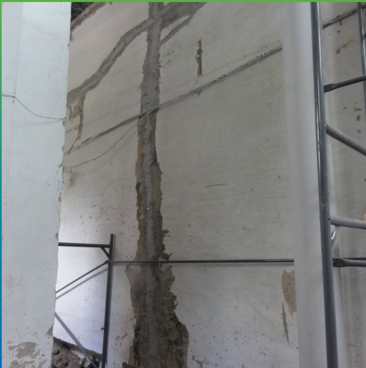
Вид зачеканенной трещины
