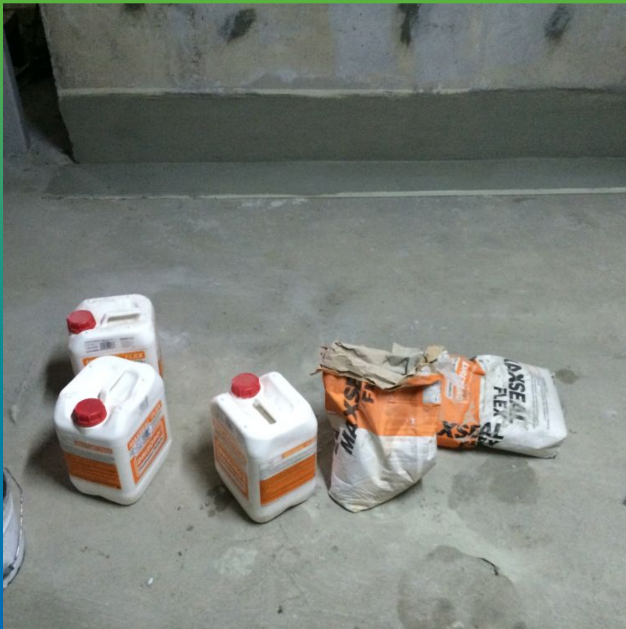
Примыкание стена/пол. Гидроизоляция Макссил Флекс в два слоя. Внешняя сторона чаши бассейна.
