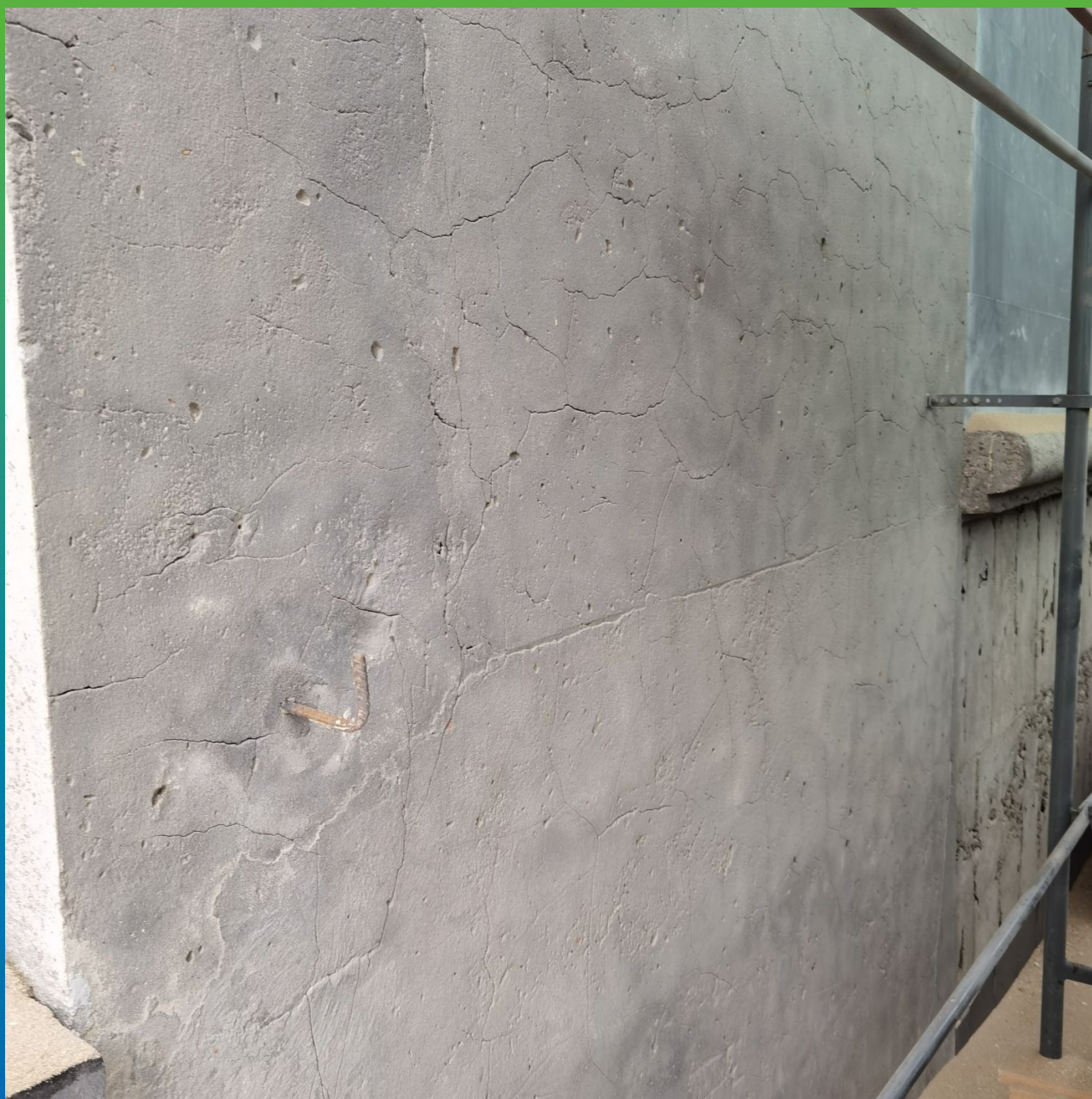
Дефекты конструкции при ближайшем рассмотрении
