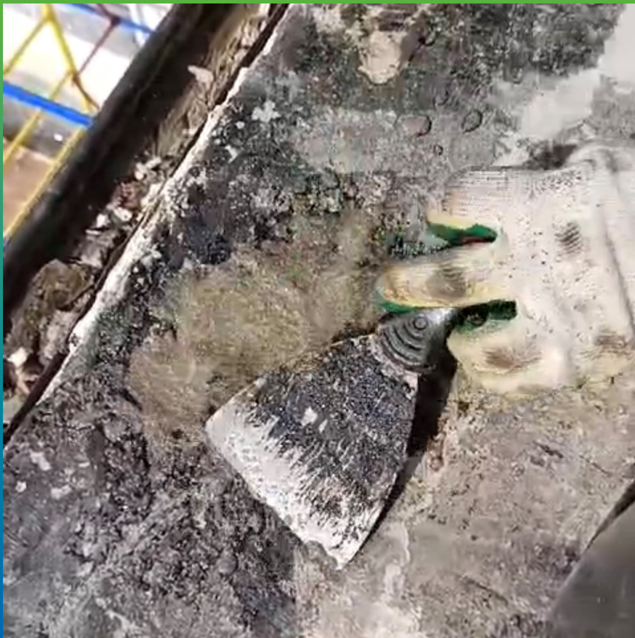
Ремонт каверн и раковин смесью материалов ДенсТоп Филлер 01 / ДенсТоп ЭП 106 в пропорции 4/1.
