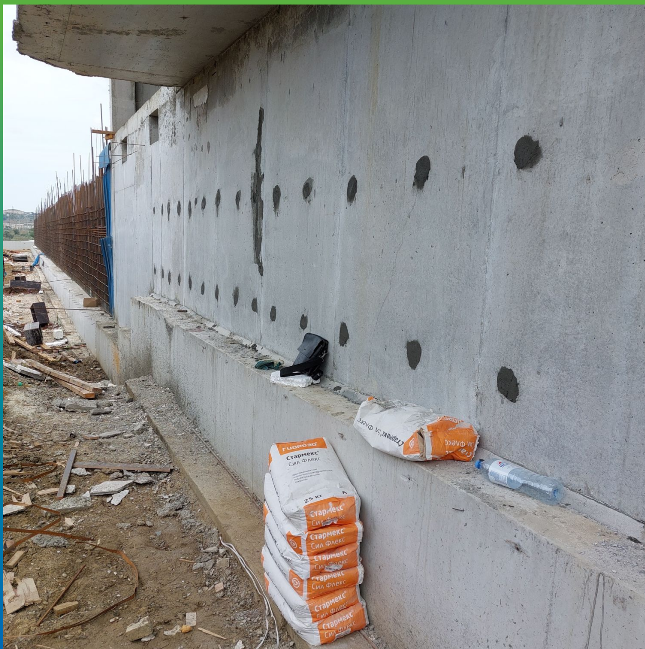
Загерметизированные отверстия от шпилек опалубки и отремонтированная усадочная трещина составом Стармекс РМЗ
