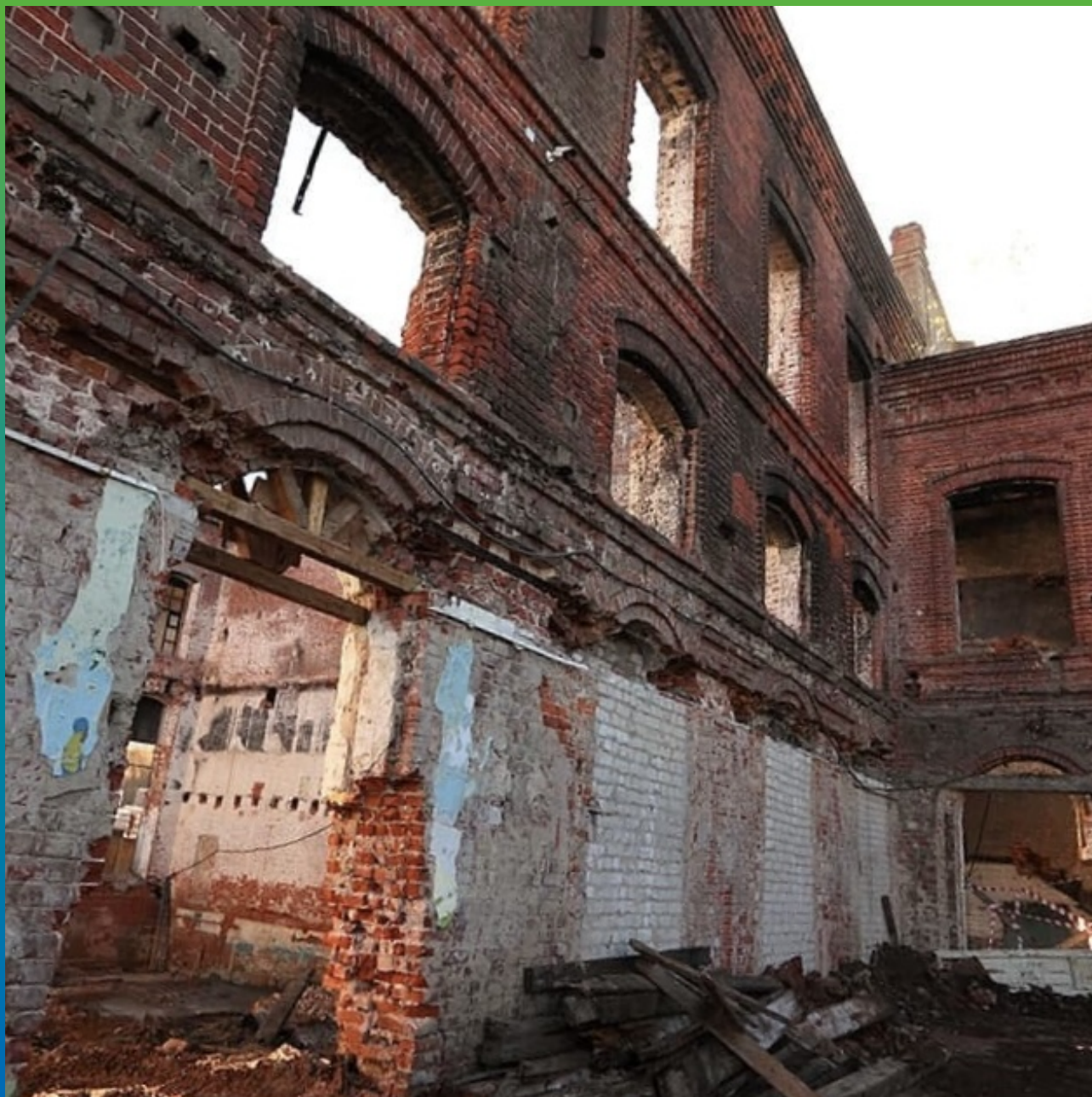
Состояние конструкций после пожара в 2017 году и длительного простоя
