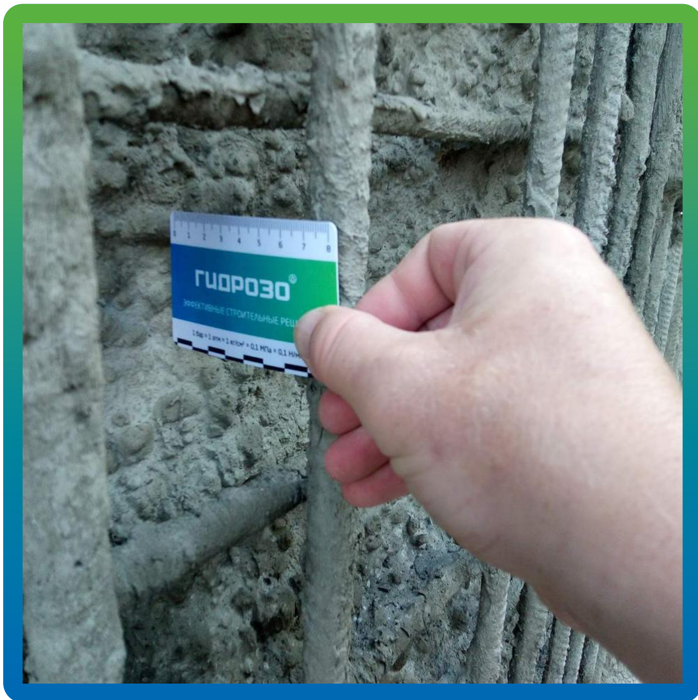
Оценка глубины разрушения защитного слоя бетона после нанесения Стармекс МКП
