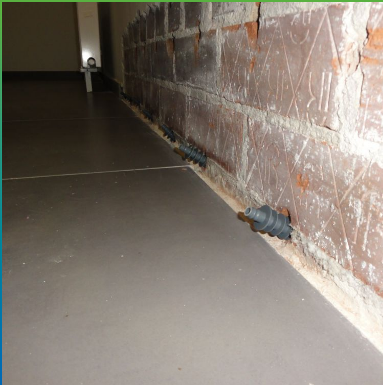
Вид установленных пакеров БМ 2830
