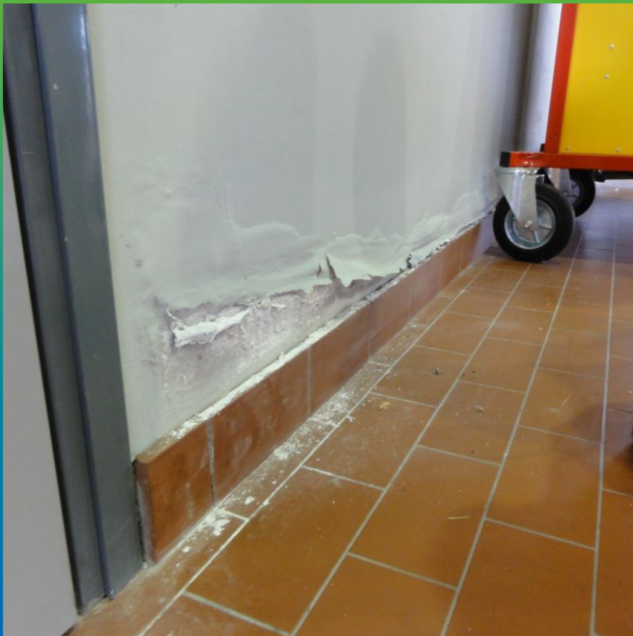
Вид дефектов - следствие капиллярного подсоса влаги по кирпичной кладке
