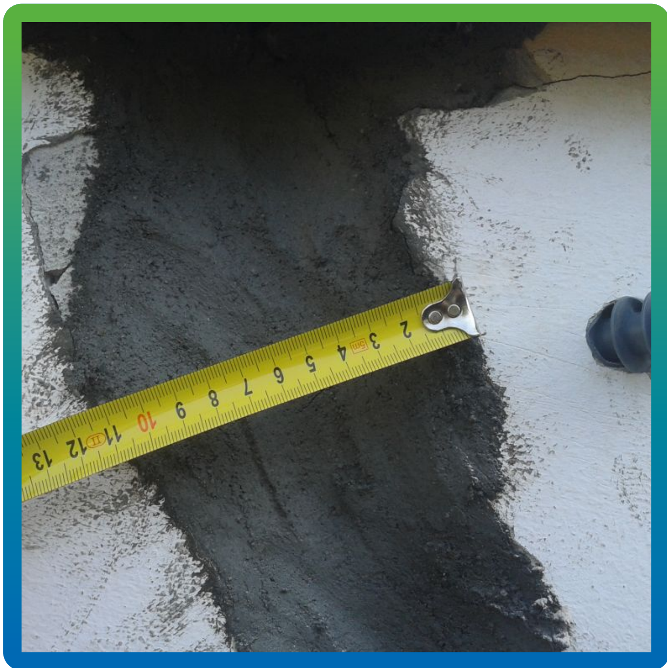
Прокаченная и зачеканенная трещина
