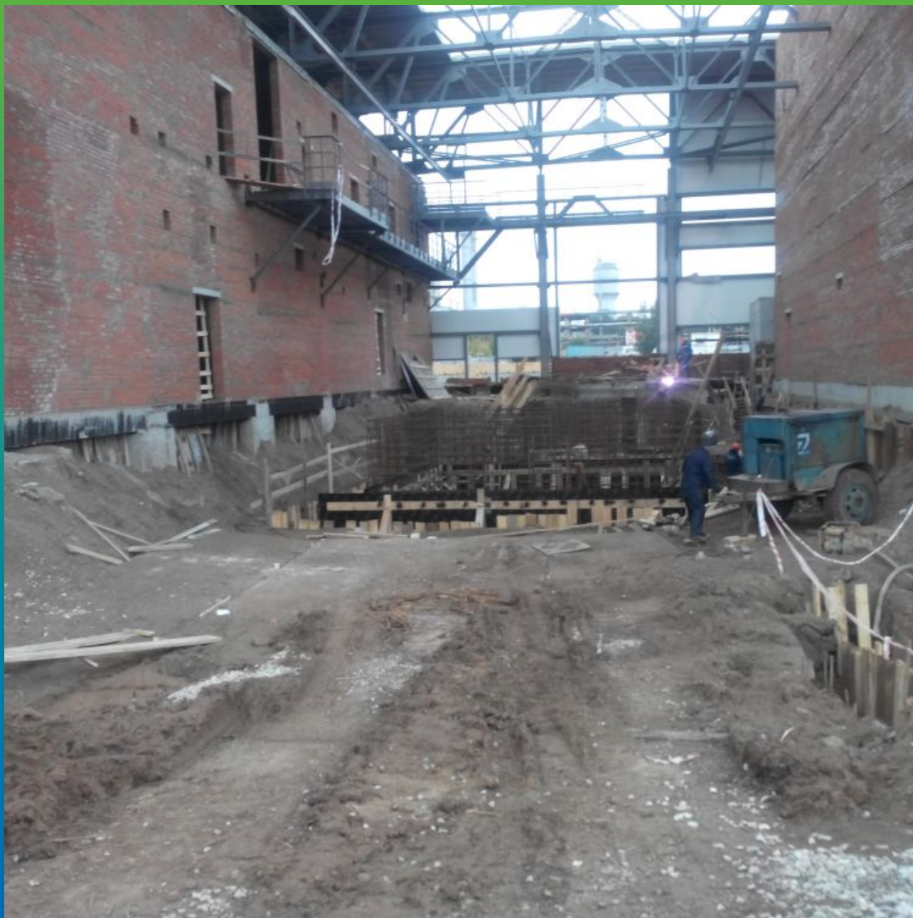
Установка арматурного каркаса плиты основания пола и гидроизоляция методом просыпки Макссил Супер
