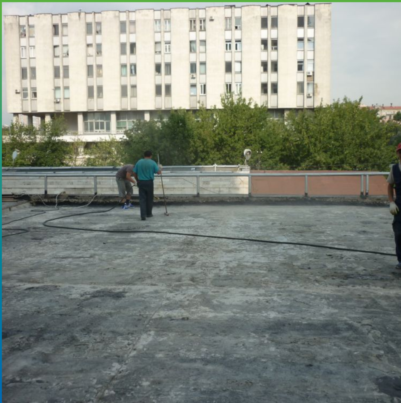
Подготовка основания перед укладкой гидроизоляционного полотна из ЭПДМ мембраны Эластосил Т 1,2 мм
