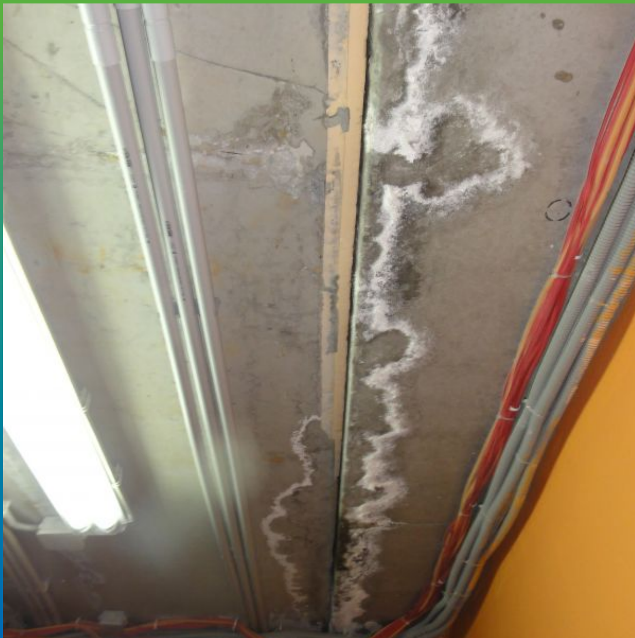
Вид на проблемный участок - шов внутри помещения
