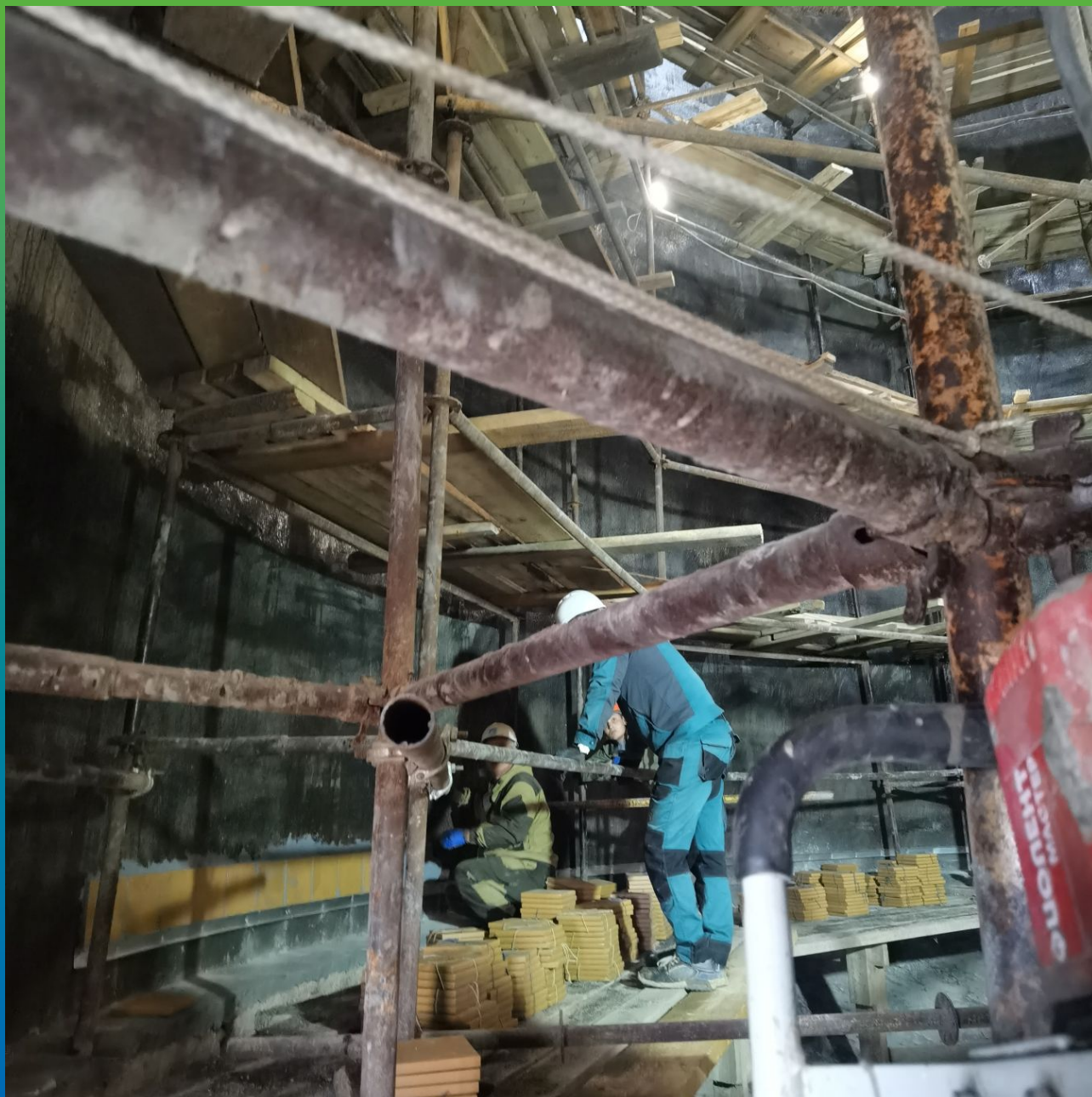
Монтаж плитки на Манопокс 331 с загустителем Манопокс Тикс при большой толщине клея
