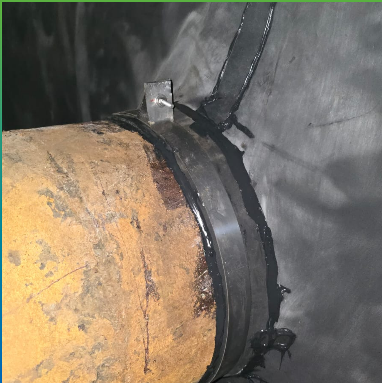
Закрепление ЭПДМ мембраны Преласта СТ 1.2 мм на трубы на герметик Манодил Бонд Ф черный и нержавеющей хомут
