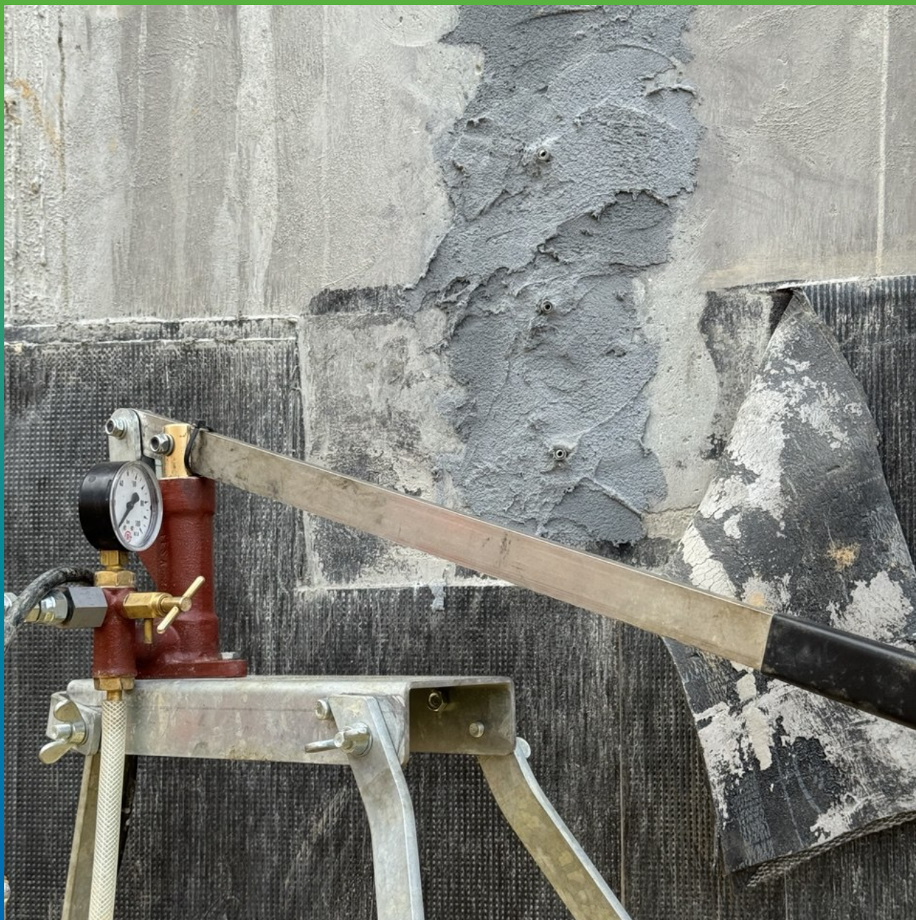
Оборудование на объекте БМ 0303
