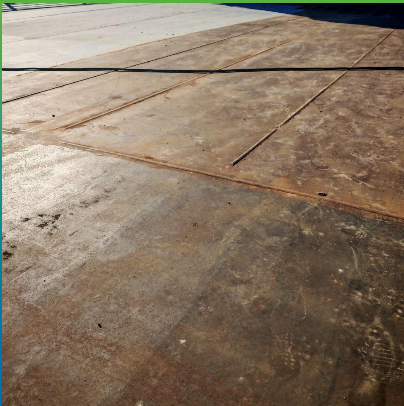
Ортотропная плита проезжей части путепровода, вид неподготовленной поверхности
