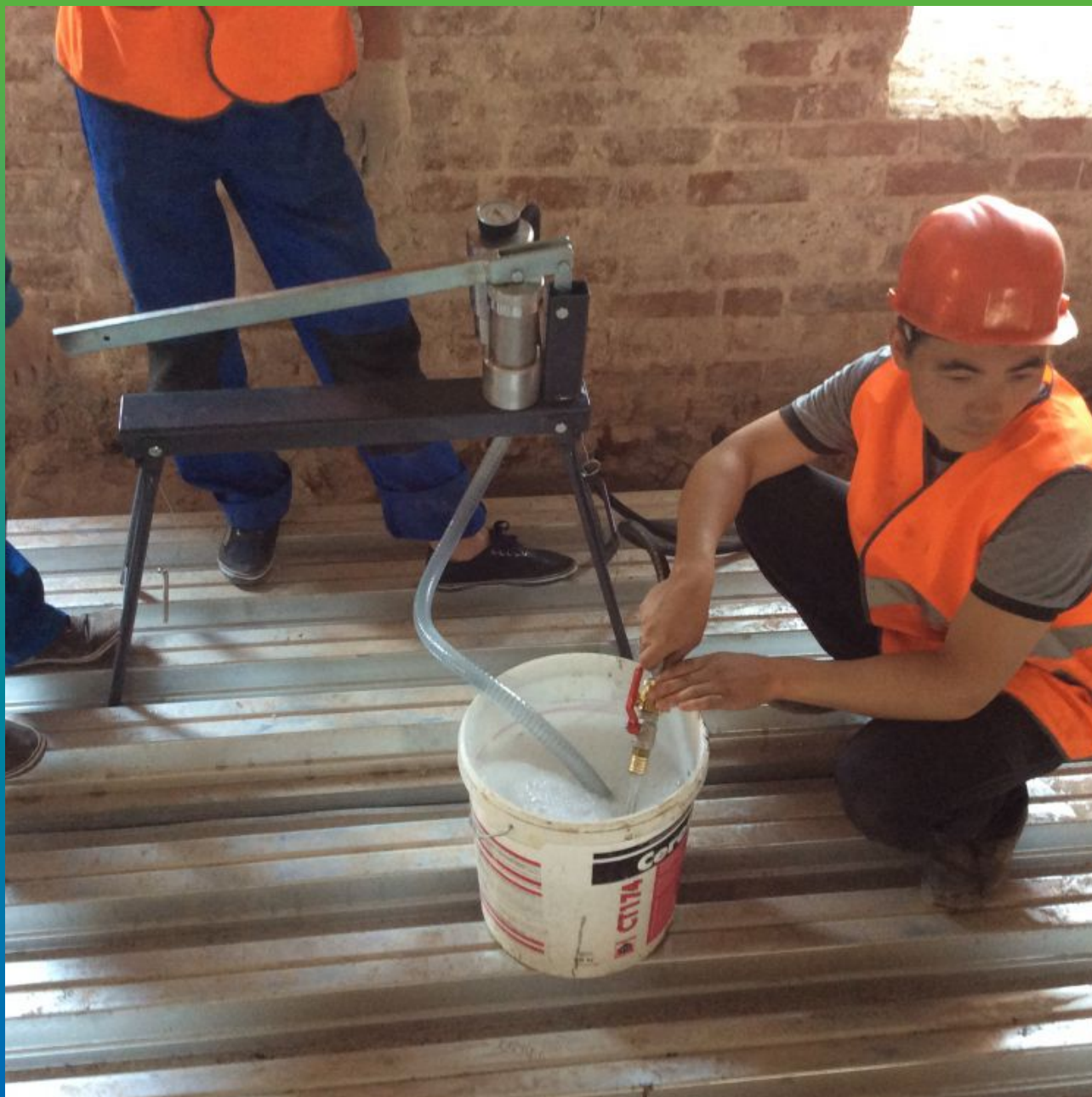
Первый запуск насоса БМ 0220, на воде
