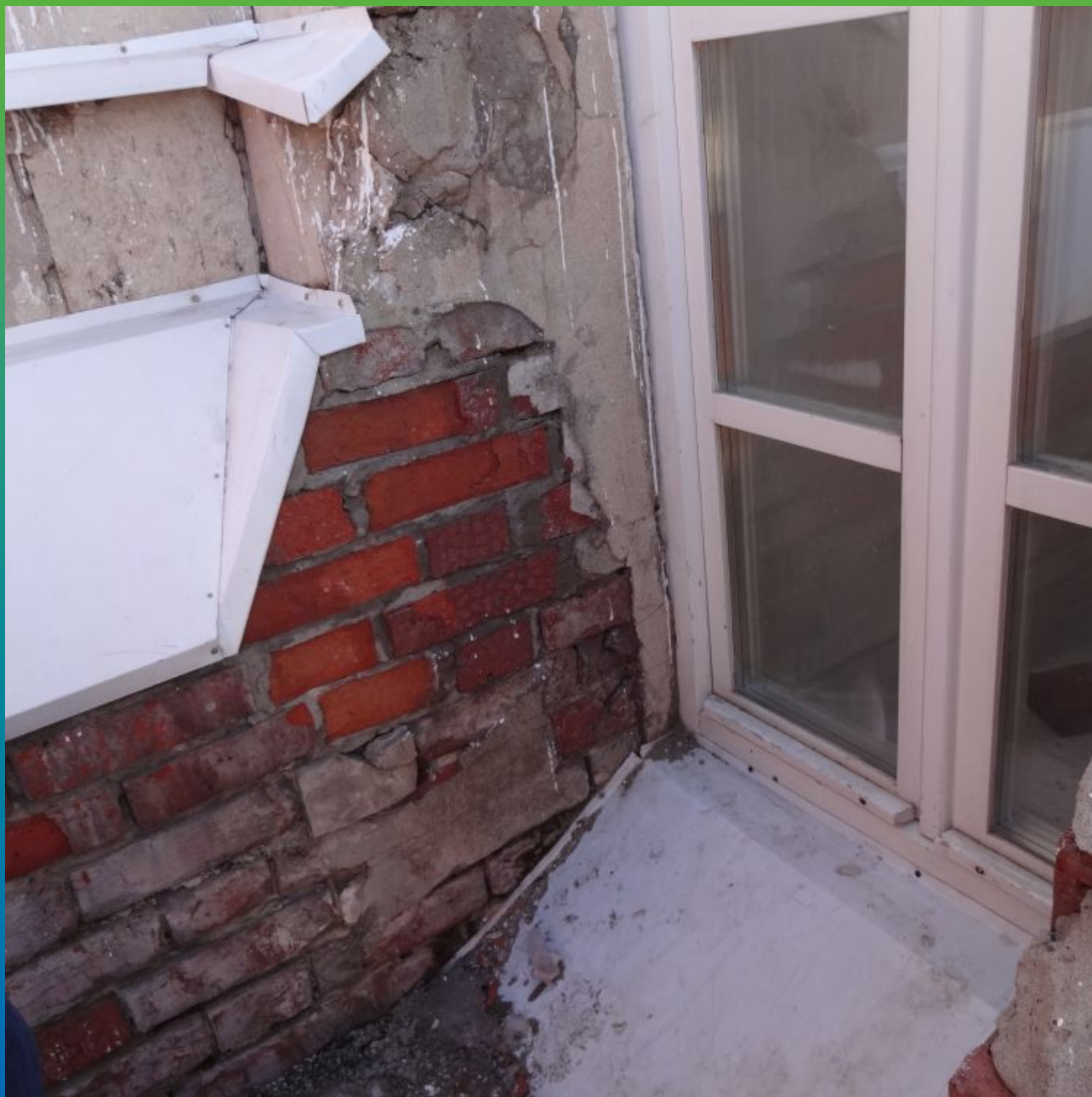
Замачивание штукатурки, разрушение кирпичной кладки
