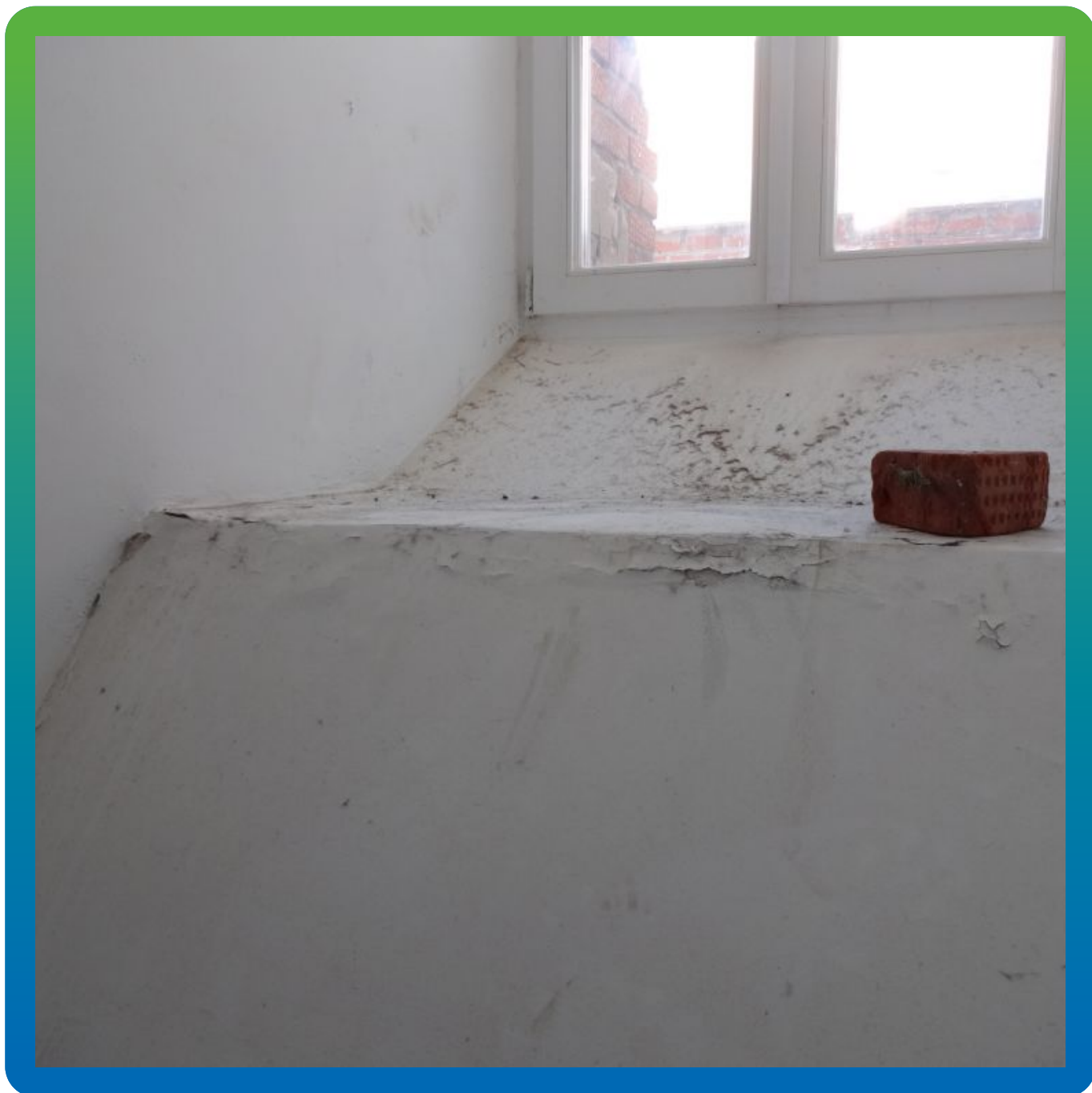
Замачивание штукатурки, разрушение кирпичной кладки
