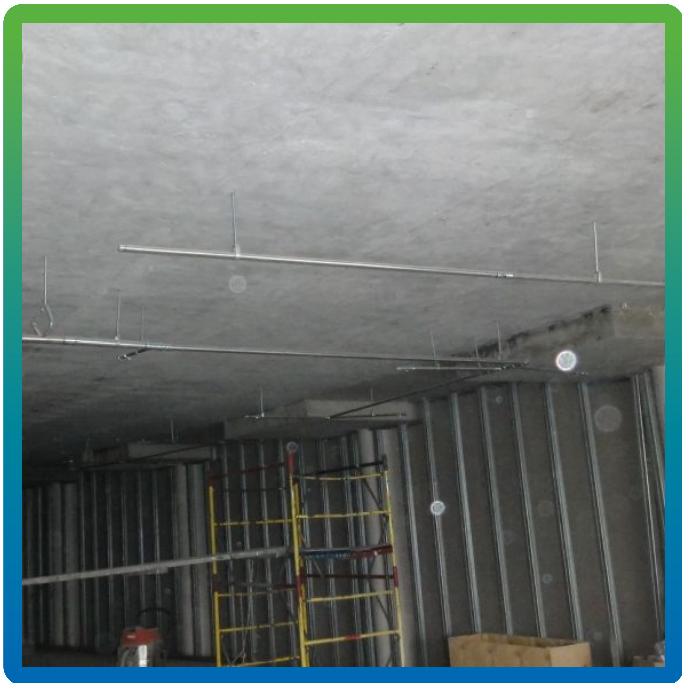
Общий вид участка под усиления. Вид на основание и дефекты.
