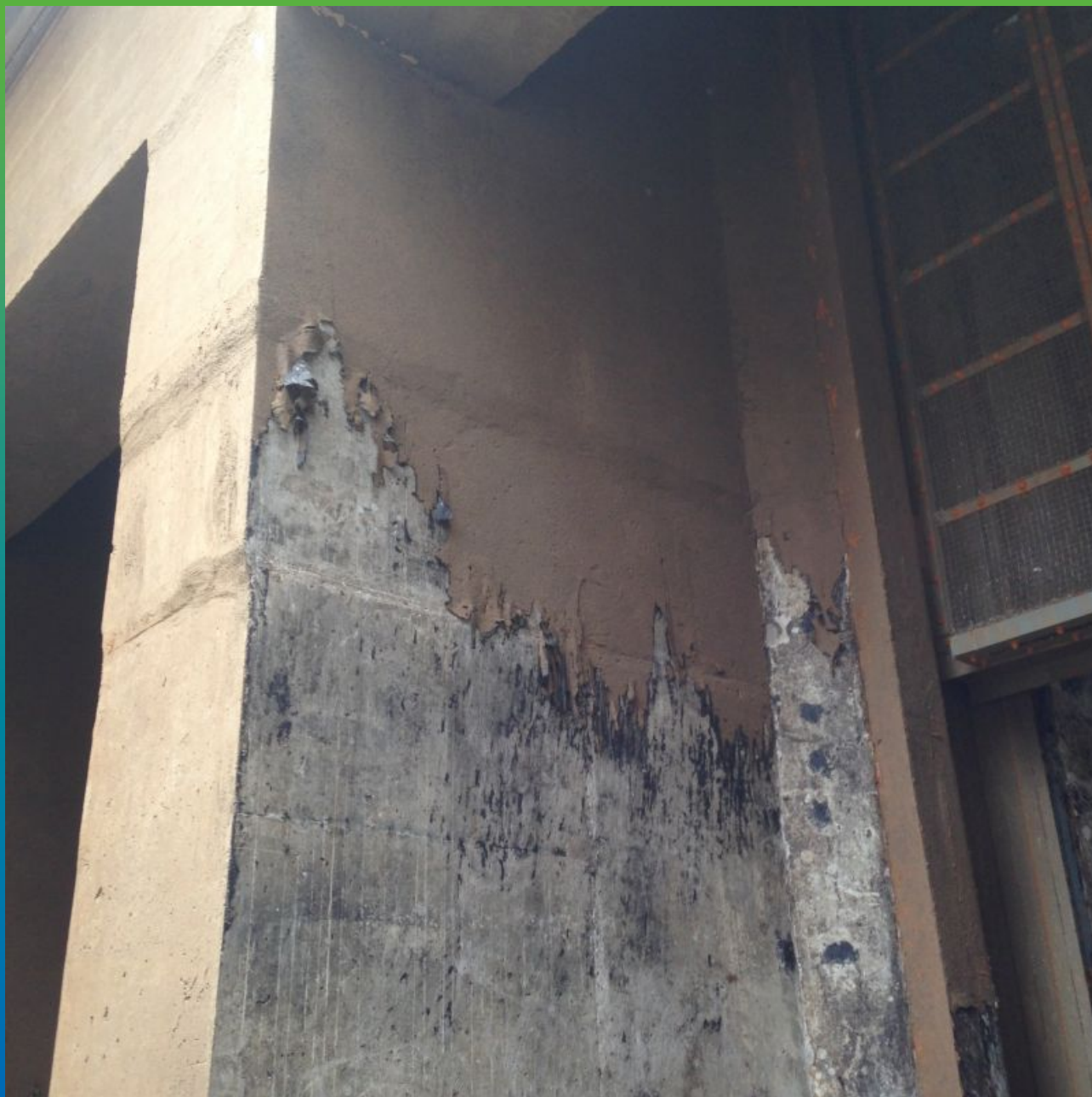
Детализация дефектного покрытия. Удаление покрытия.
