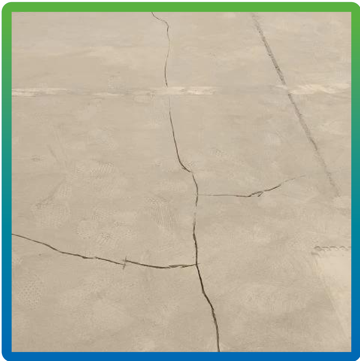
Основание после шлифовки, основные дефекты
