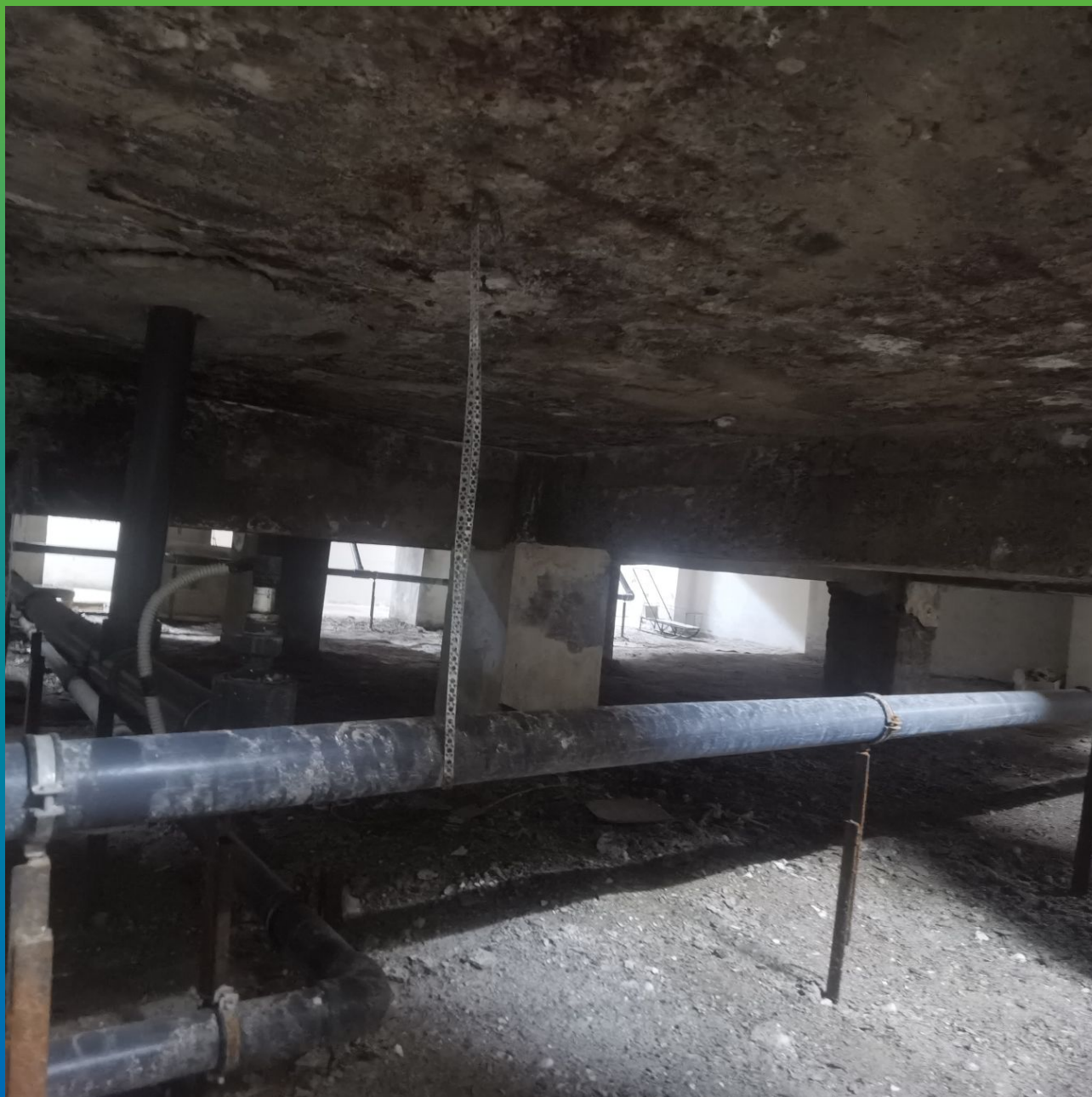
Дефекты ж/б до проведения работ по ремонту и усилению
