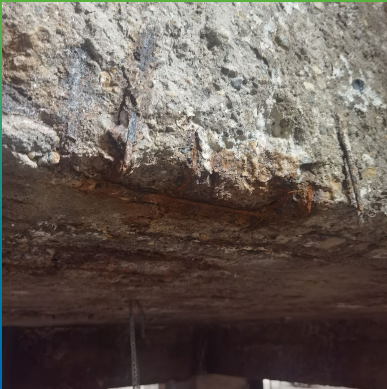
Коррозия арматуры и разрушение защитного слоя ж/б
