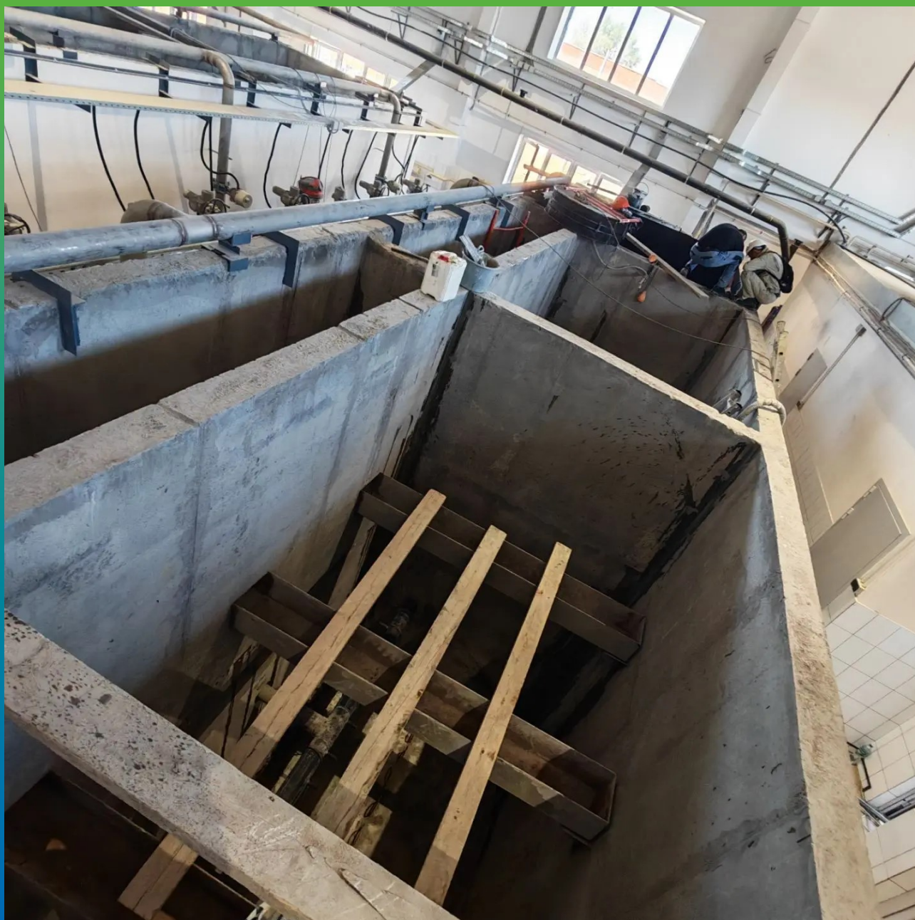
Резервуары насосной станции
