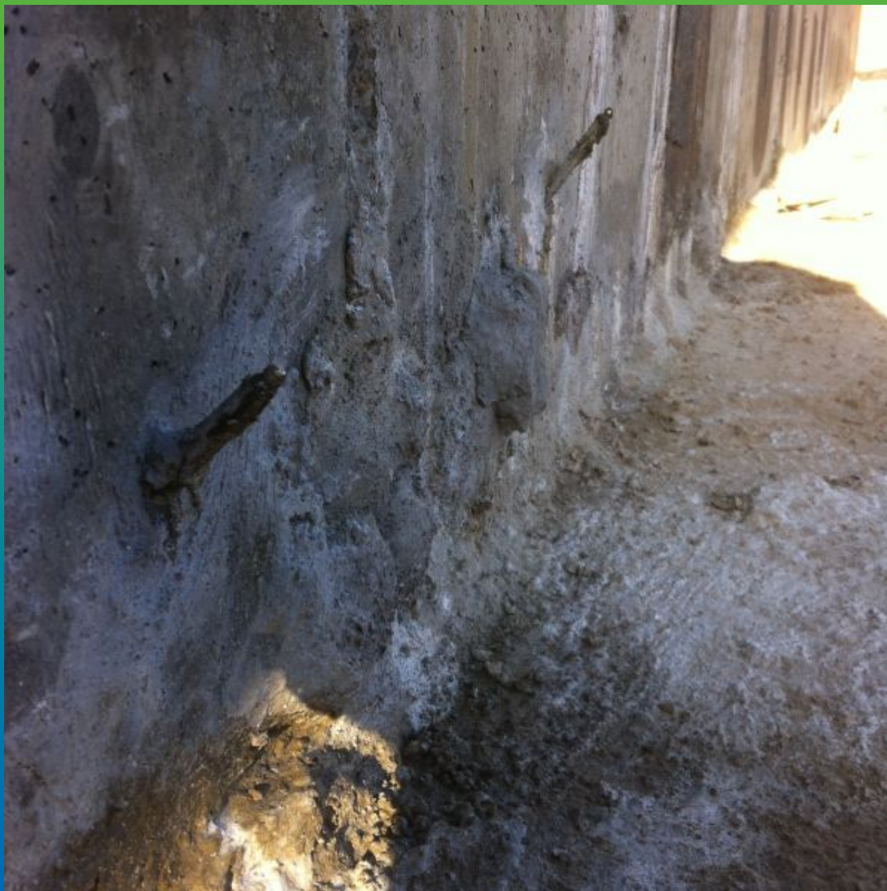
Вид "Холодного шва" после инъектирования Манопур У
