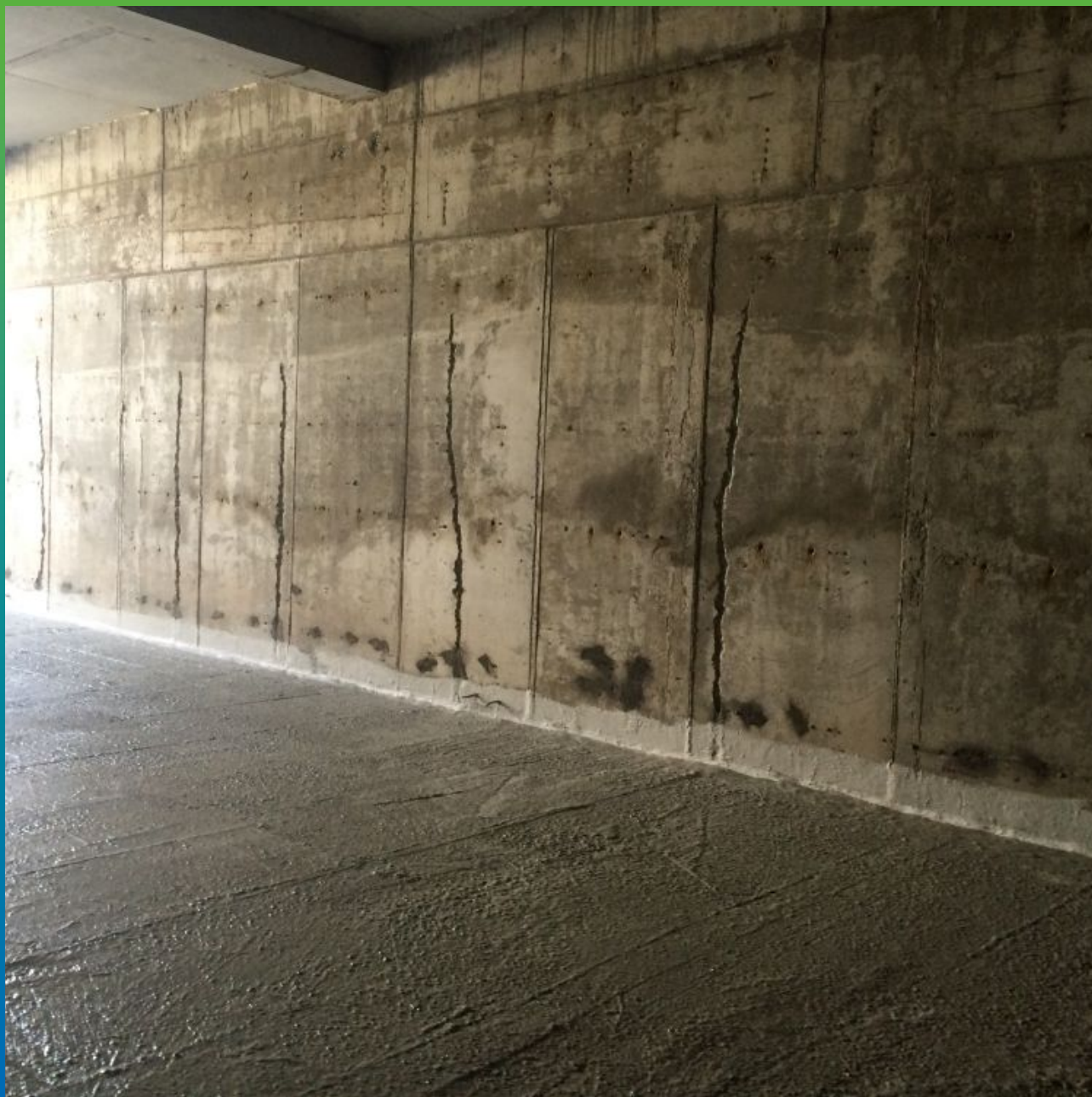
Образование трещин после заливки стен резервуара
