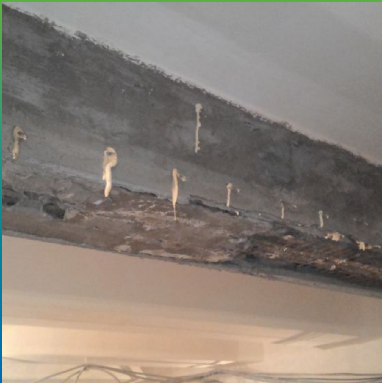
Последствия инъекирования перехода.
