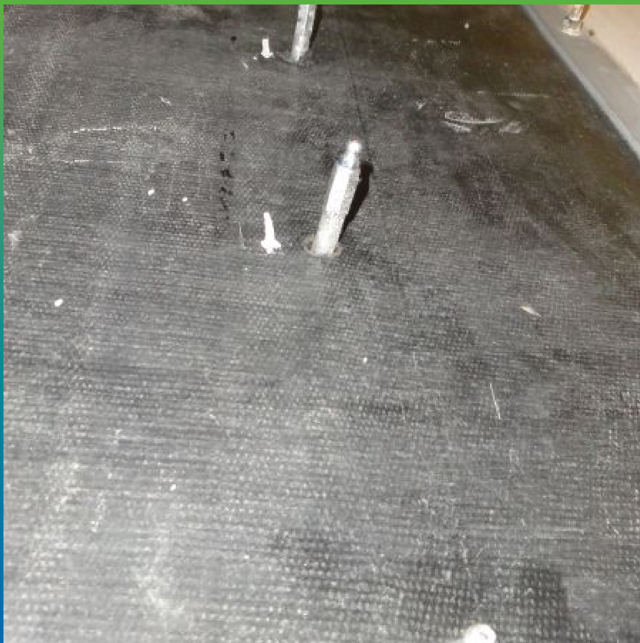
Вид установленных пакеров
