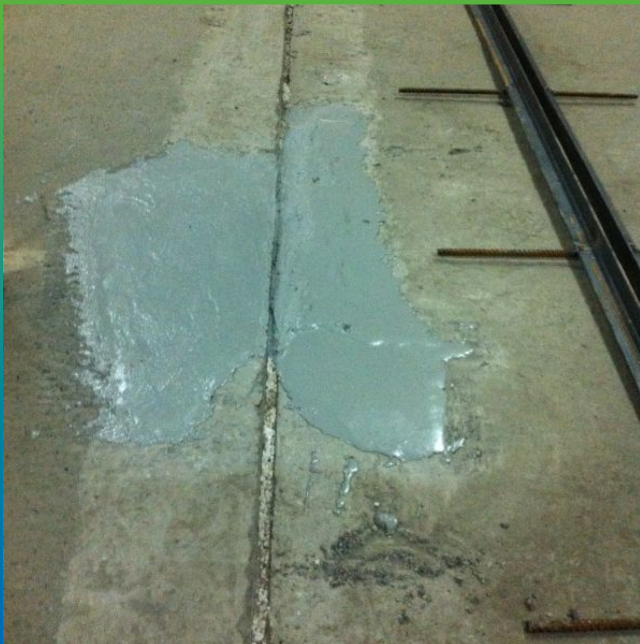
Ремонт кромок шва эпоксидным составом, для последующего устройства системы Манодил Про + Манопокс 331
