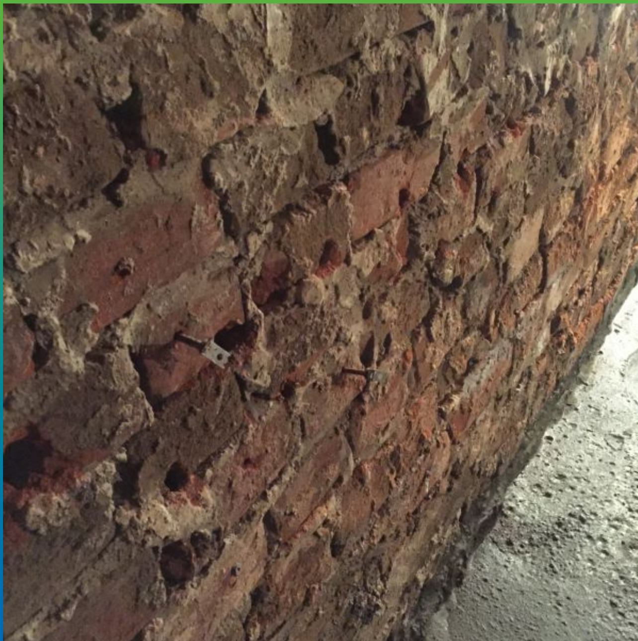
Пробуренные отверстия в толще кирпича
