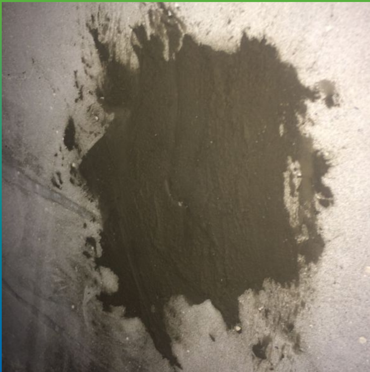
Заделанное отверстие от опалубки
