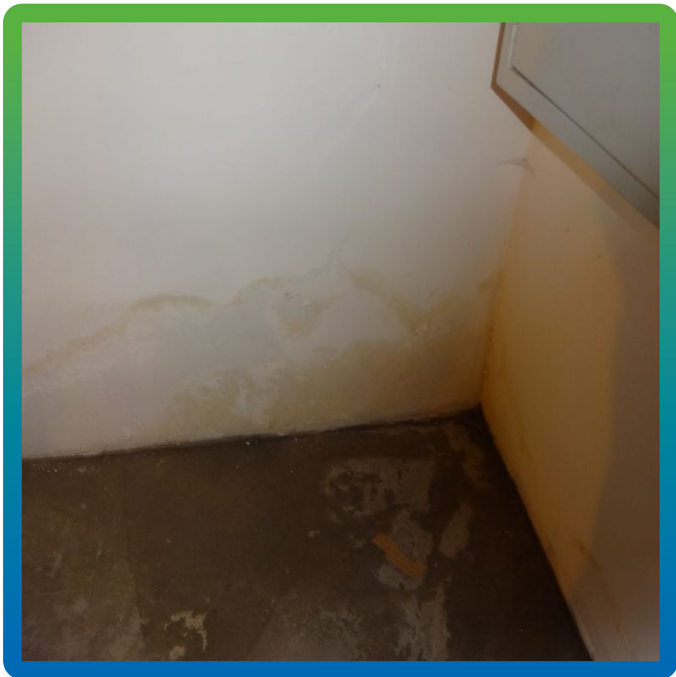
Протечки воды через шов примыкания стена - пол
