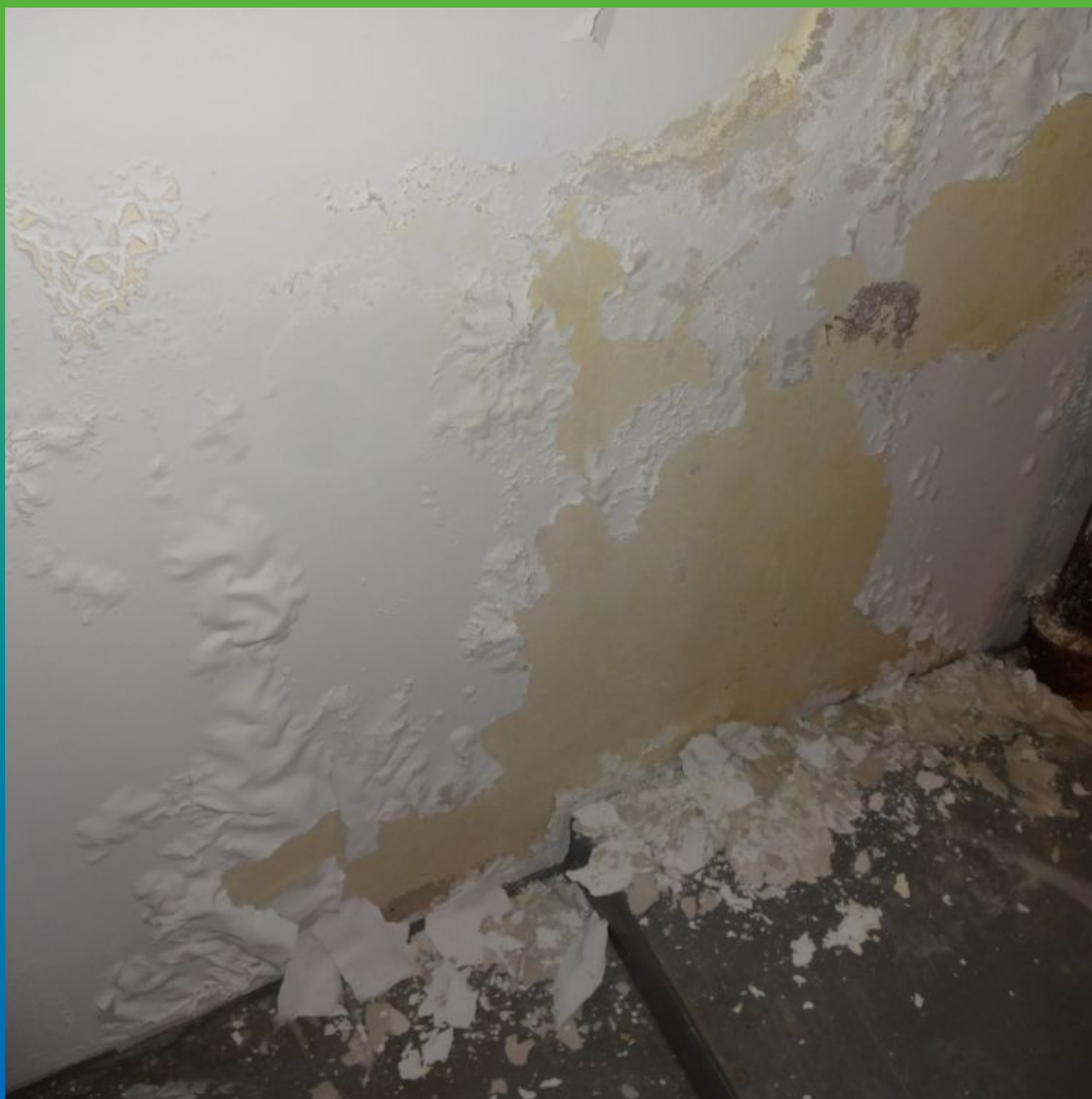
Намокание стен конструкции
