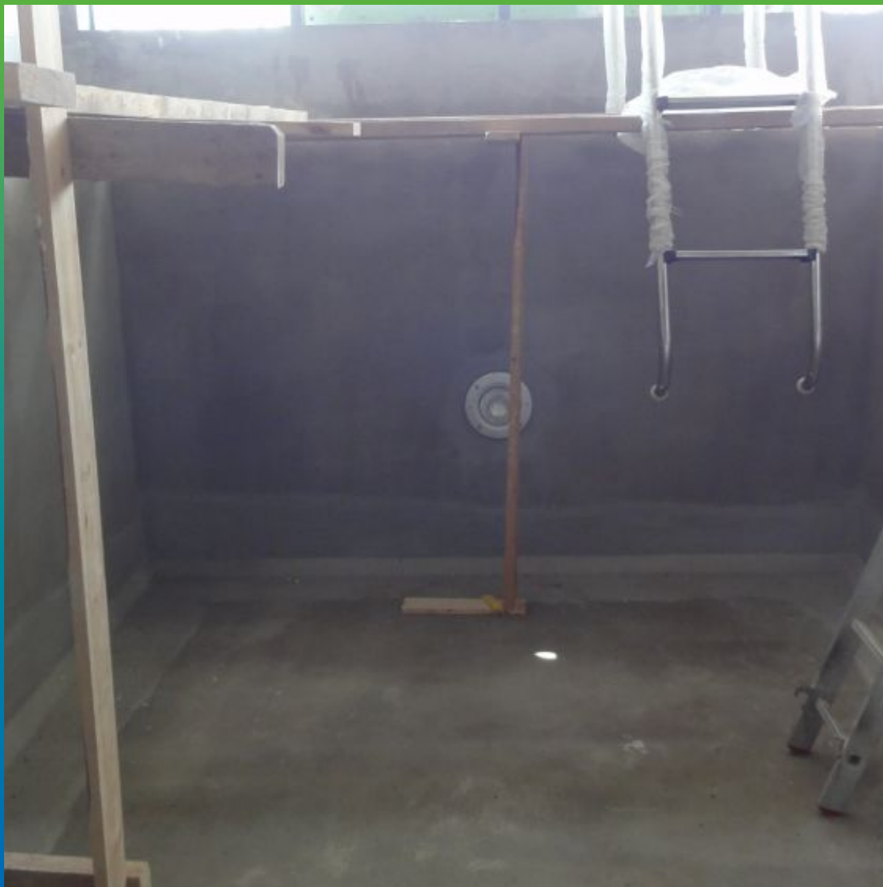
Финальный вид бассейна. стены и пол обработаны составом Макссил, примыкание стена-пол обработаны составом Макссил Флекс.
