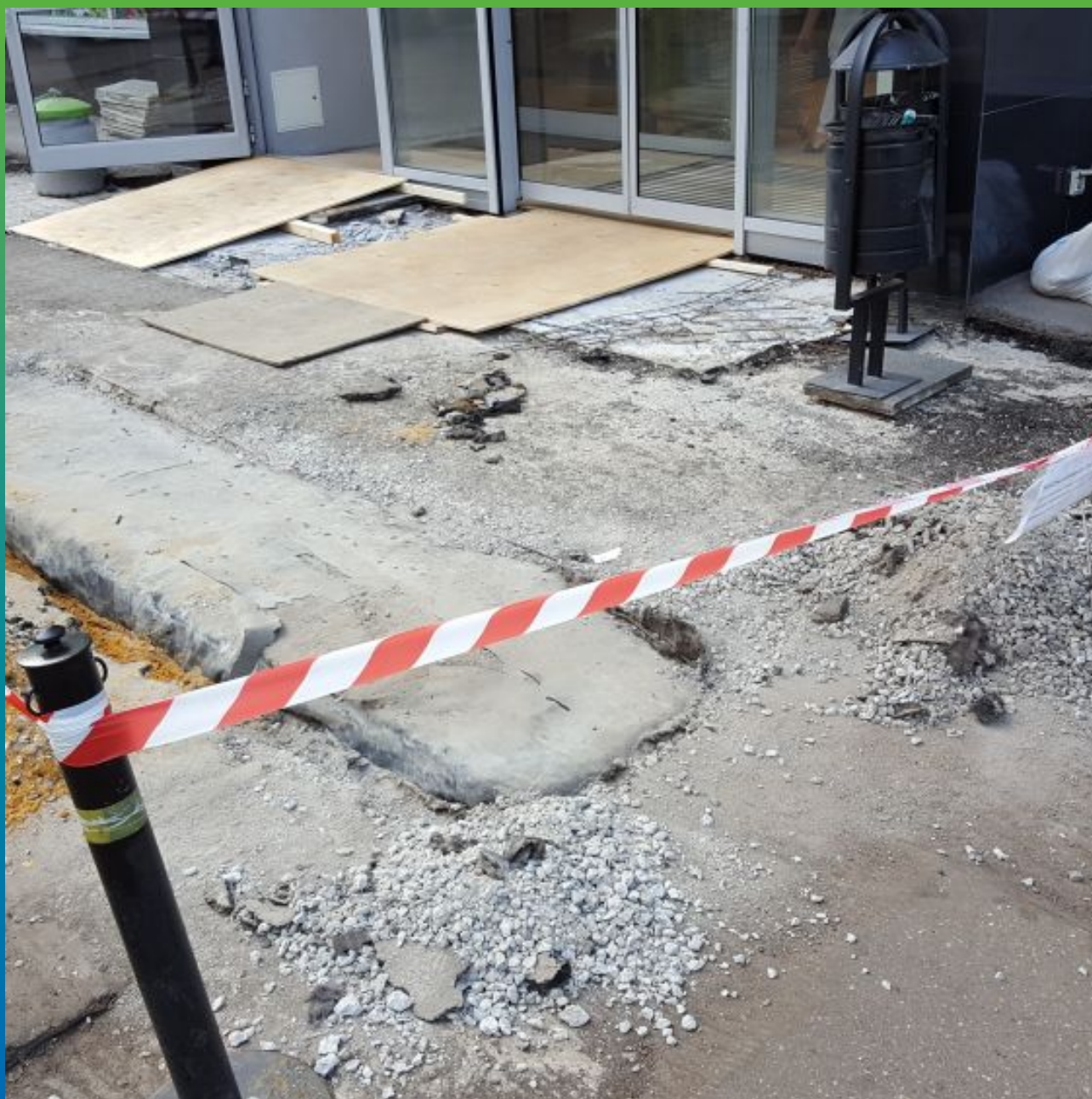
Локальное повреждение ЭПДМ мембраны Преласты СТ, при устройстве нового дорожного покрытия
