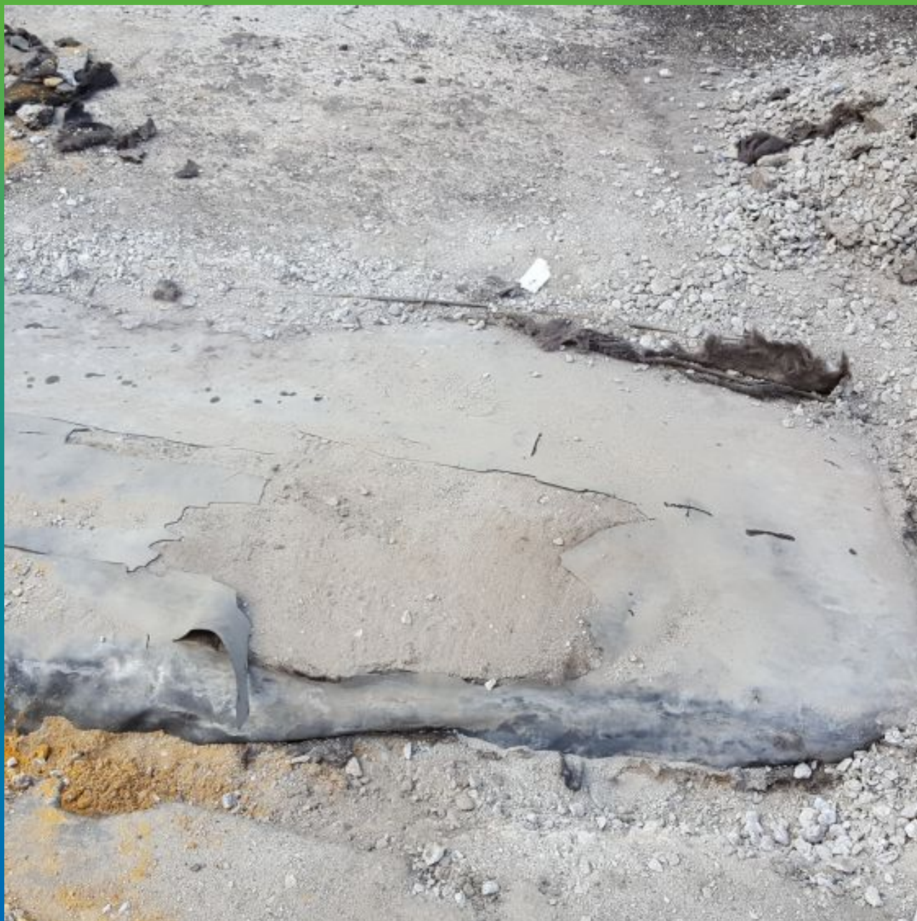
Локальное повреждение ЭПДМ мембраны Преластит СТ, при устройстве нового дорожного покрытия
