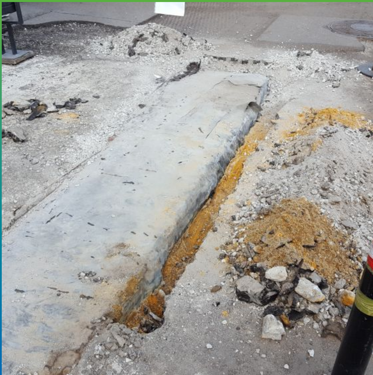
Локальное повреждение ЭПДМ мембраны Преласта СТ, при устройстве нового дорожного покрытия
