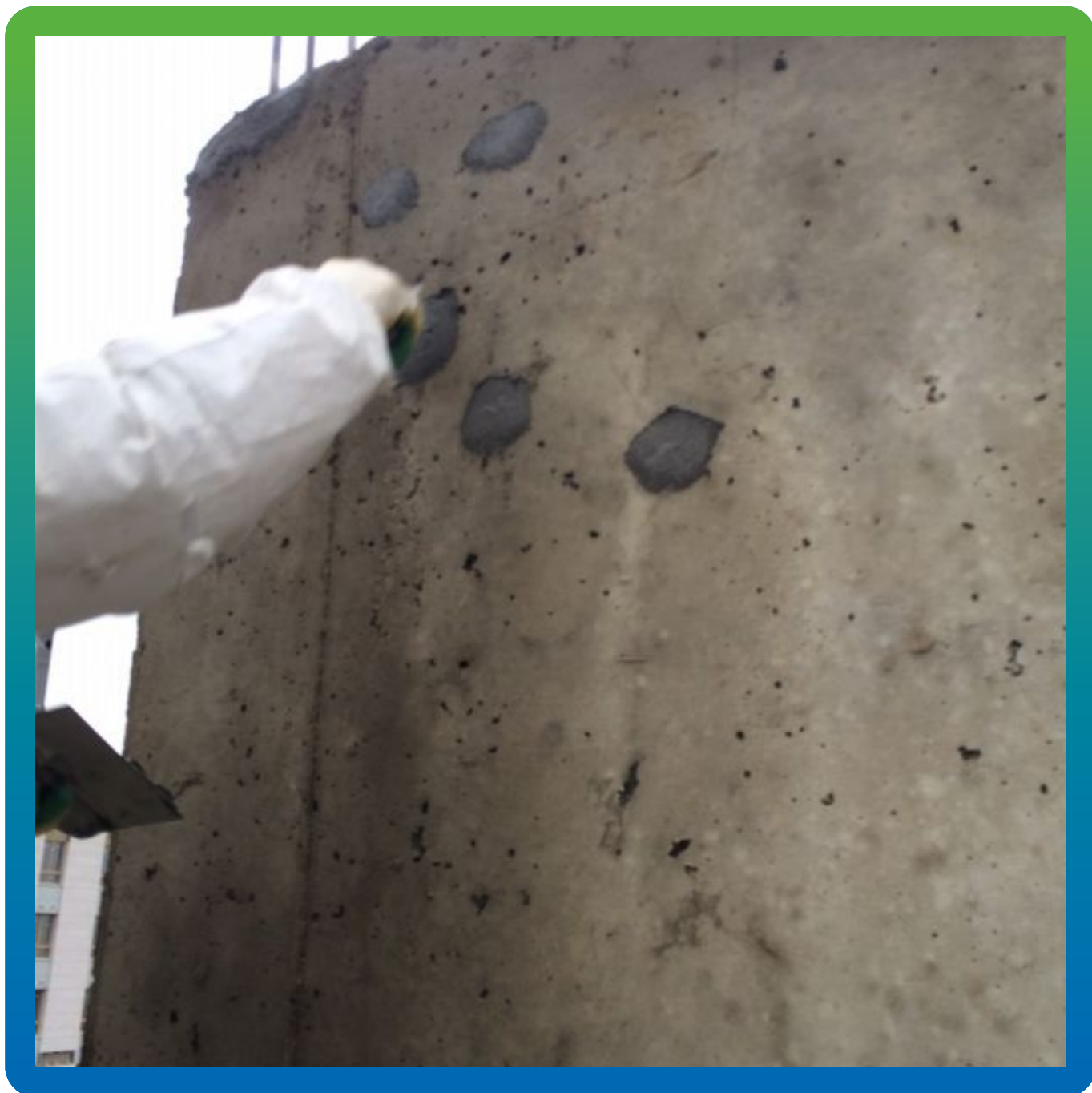
Вид конструкции с восстановленной геометрией при помощи Стармекс РМЗ
