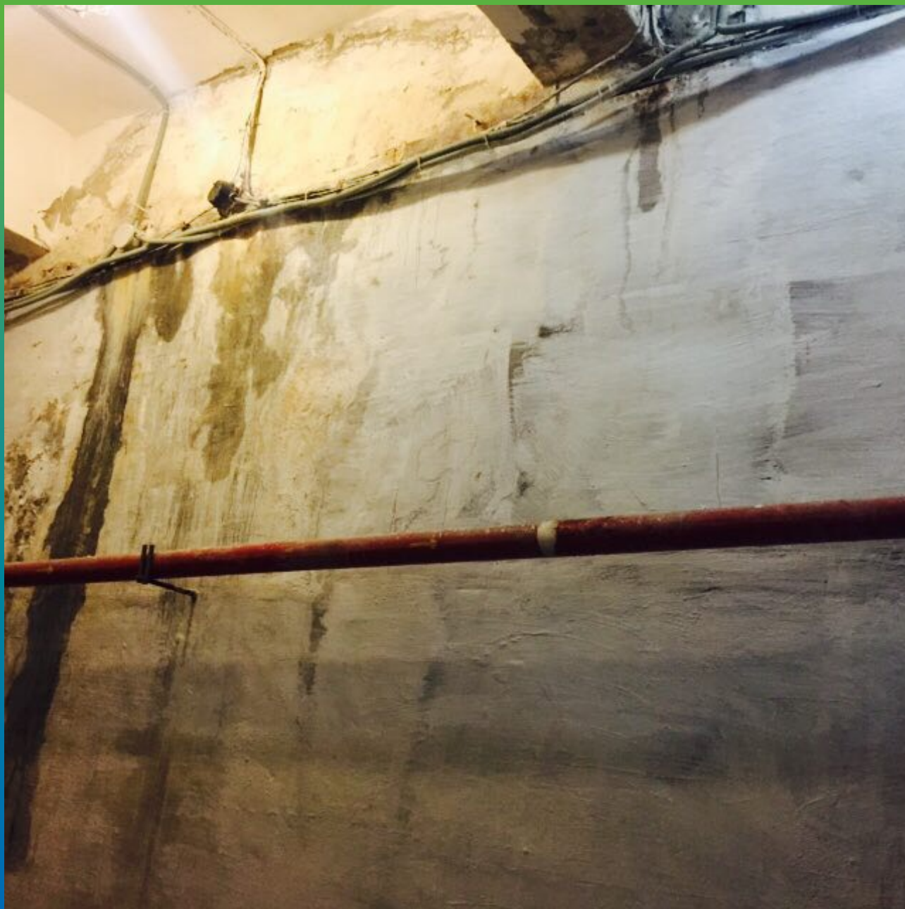
Дефекты бетона с активными протечками.
