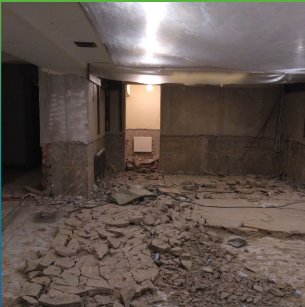
Вид подвальной части до устройства новой гидроизоляции из ЭПДМ мембраны Преласта СТ
