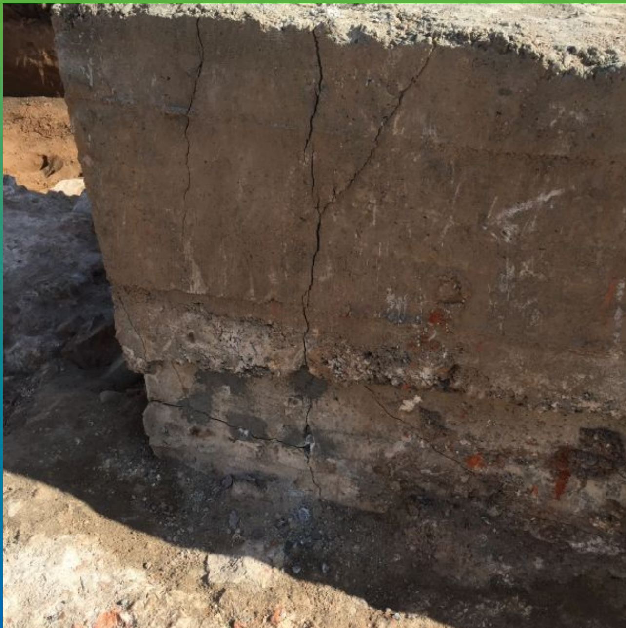
Разрушение после 30 часов
