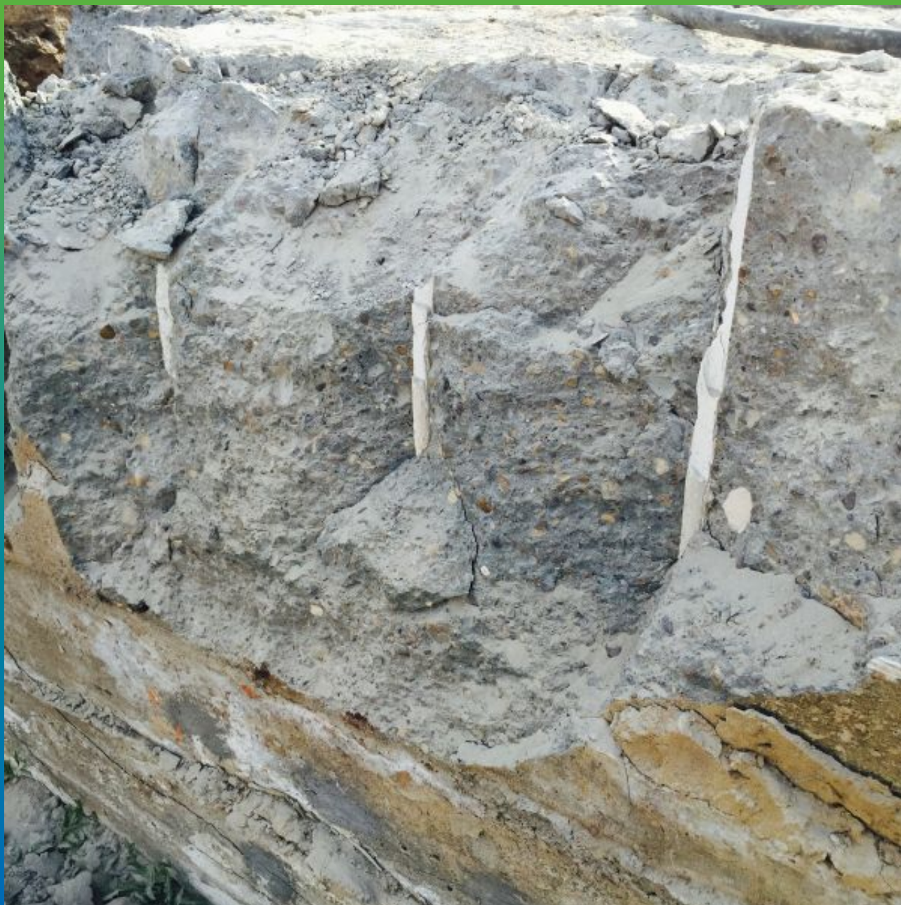
Разрушение после 48 часов
