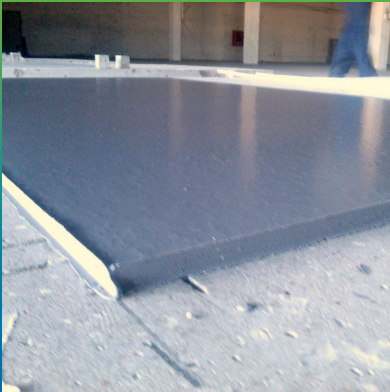
Смонтированная система ЦПУ
