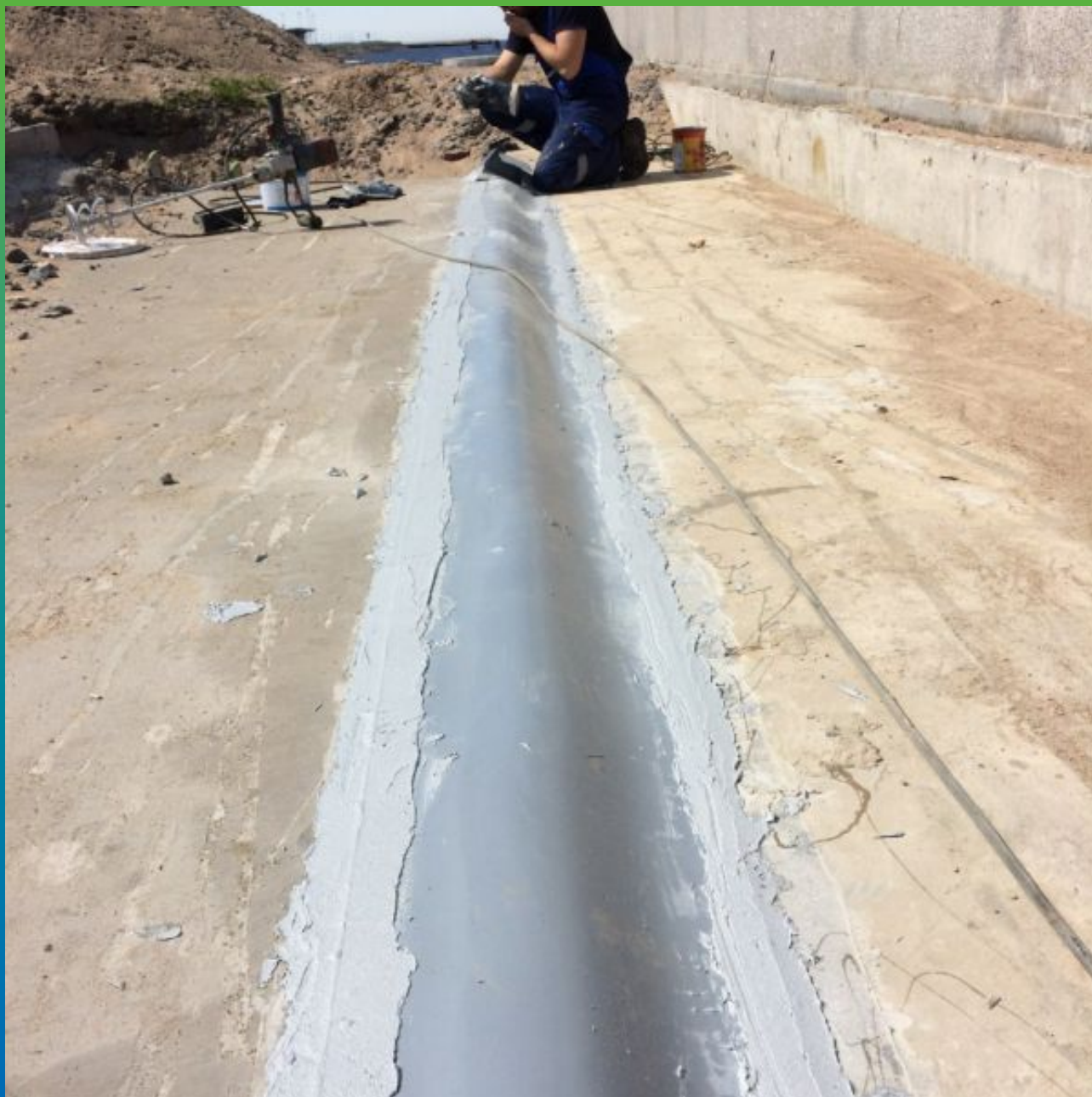
Смонтированная система Манодил Про и Манопокс 331
