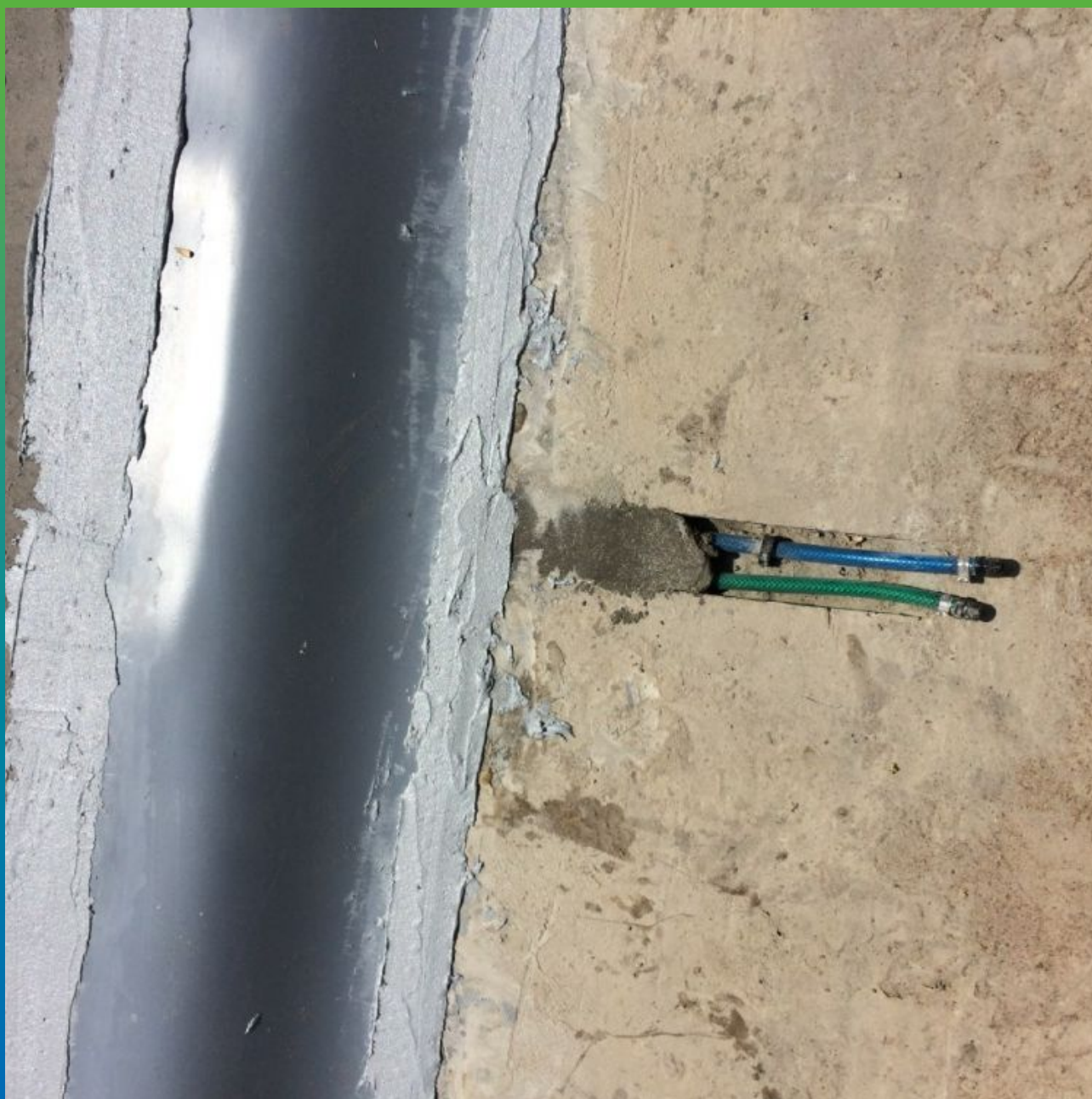
4 Вид на выводы системы Инжпайп для аварийного инъецирования
