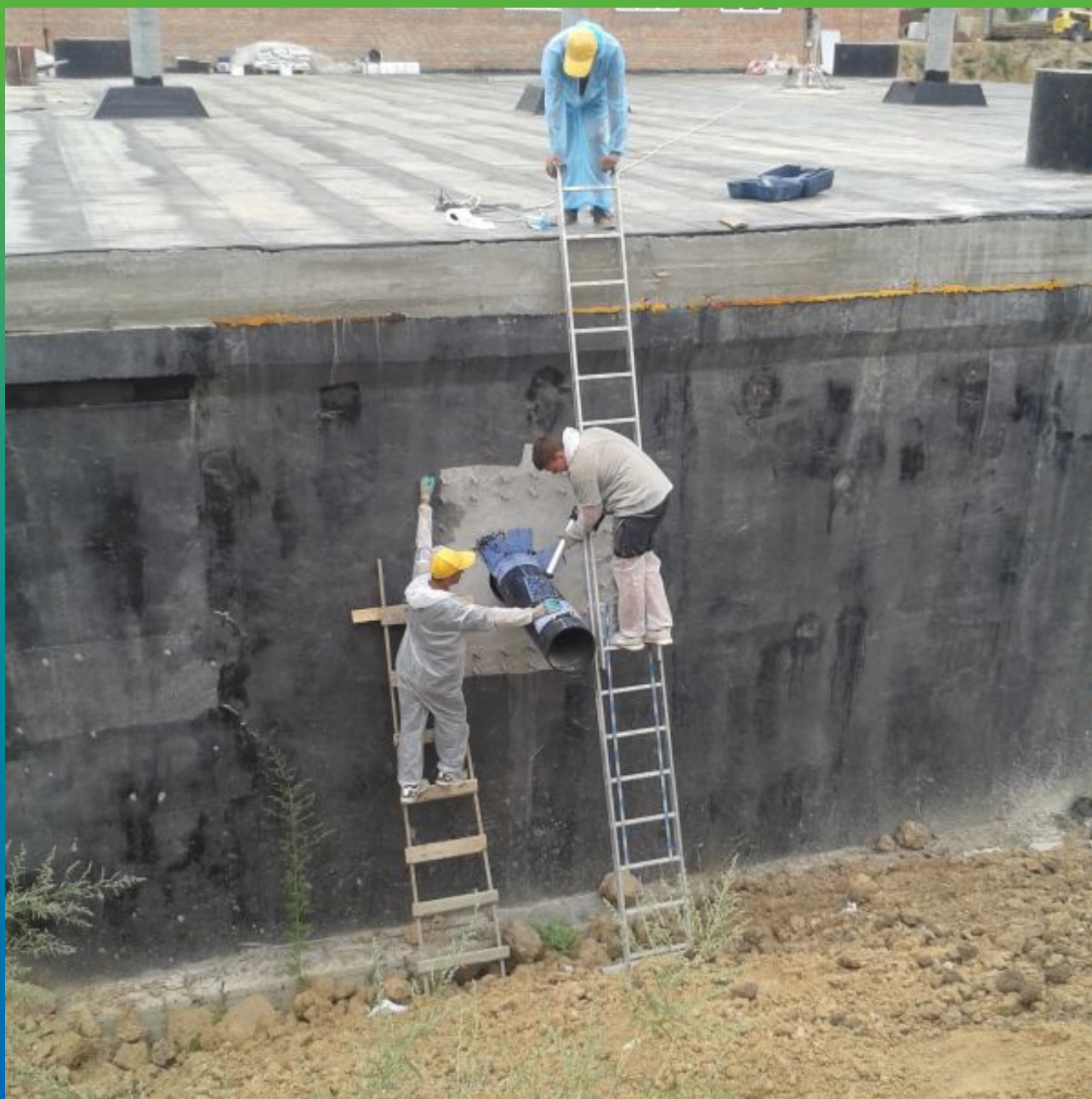
Монтаж эластичной гидроизоляционной ленты Манодил Гео к поверхности пластиковой трубы и к бетону
