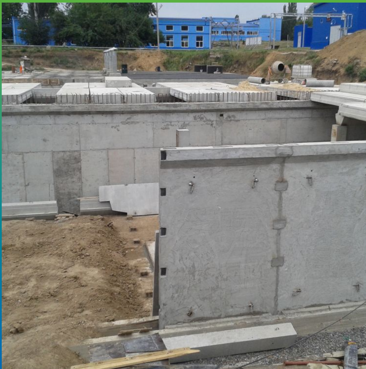
Общий вид резервуаров-отстойников
