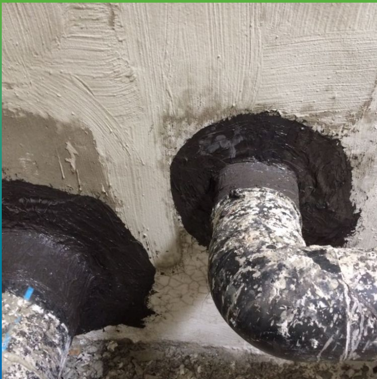
Два ввода коммуникаций
